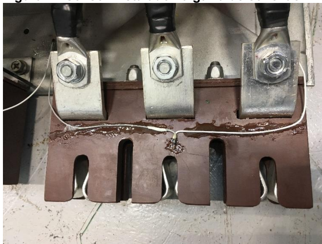
Figura 1 - Sensor instalado na garra de conexão
