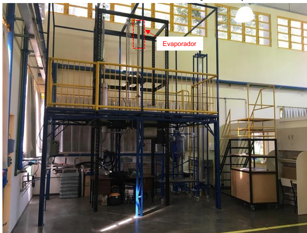
Figura 10 - Vista da caldeira de LFC do LProT com a localização do evaporador analisado
