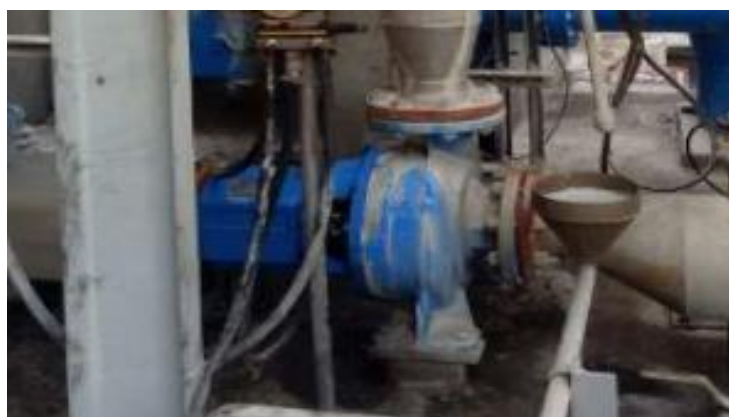
Foto da bomba do poço de coleta – TAG 3070-26-3531-3
