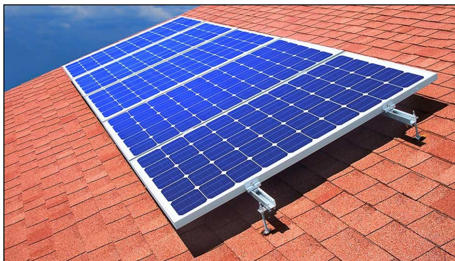
Figura 4 – Matriz de painéis solares fotovoltaicos
