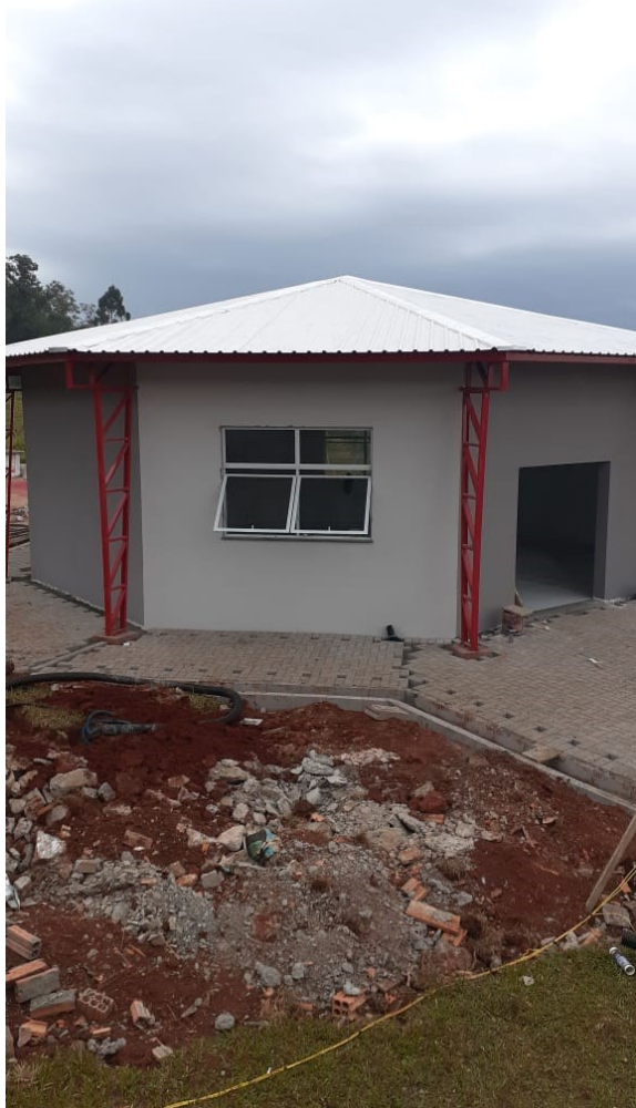
Figura 11 - Forma de acondicionamento de RCC inadequada
