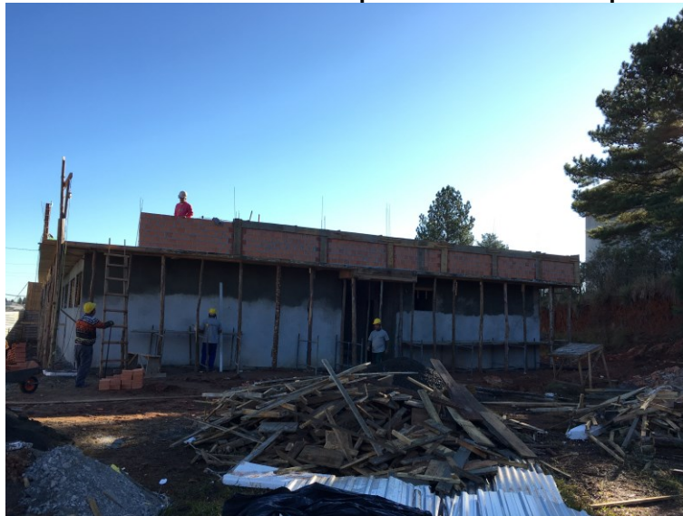
Figura 13 - Resíduos de madeiras separados com destino para caldeira
