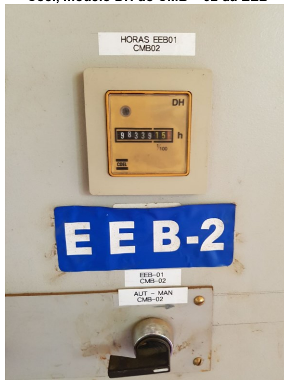
Figura 20 - Totalizador de horas da marca Coel, modelo DH do CMB – 02 da EEB
