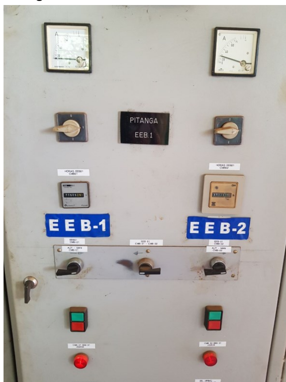
Figura 13 – Painel elétrico da EEB – 01
