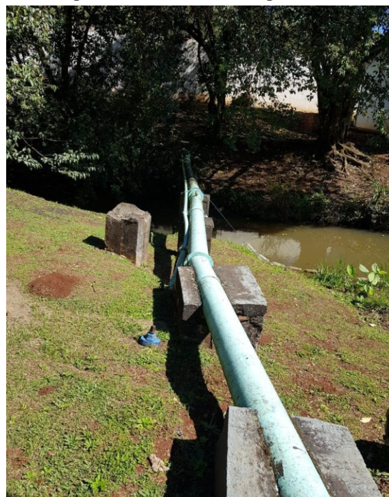
Figura 12 - Adutora de água bruta
