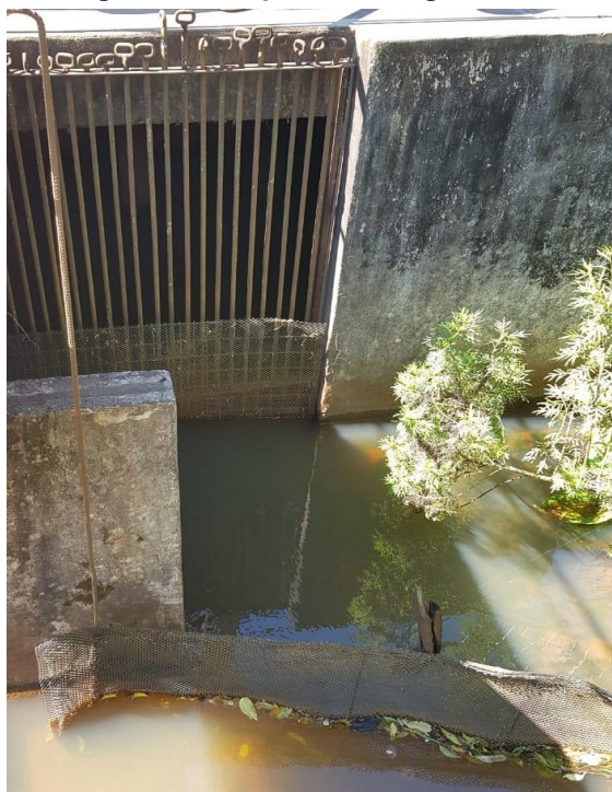
Figura 11 - Captação de água bruta
