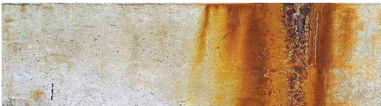
Figura 2.2: Mancha de corrosão Fonte: Lipford (2021).
