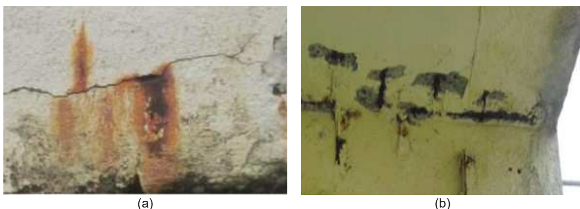
Figura 1.1: Efeitos da corrosão nas estruturas de concreto: (a) manchas e fissuras; (b) armaduras expostas por destacamento do concreto.
