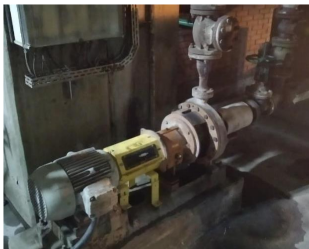
Figura 11 – Conjunto de Bombeamento de Condensado
