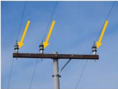
a) Isoladores elétricos em postes urbanos
