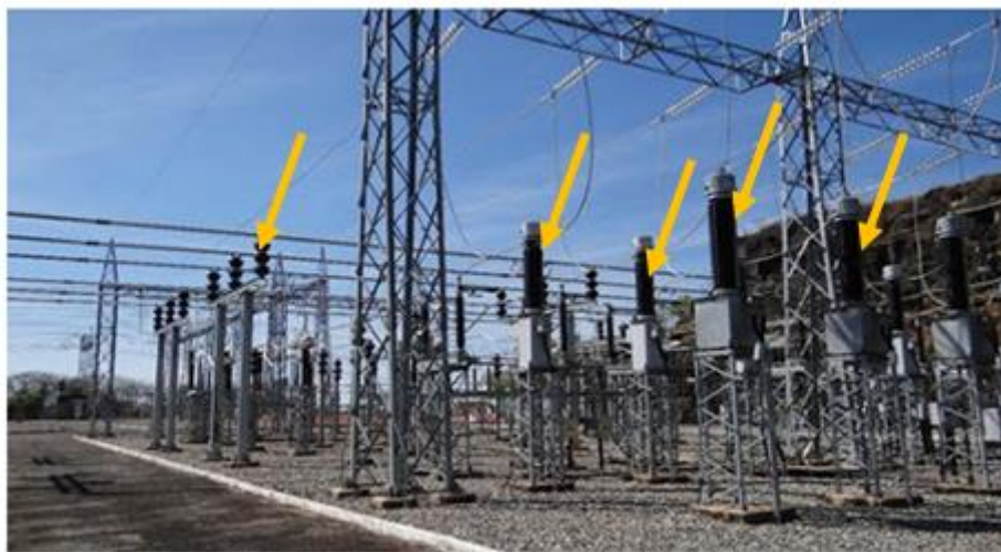
c) Isoladores elétricos em subestações
