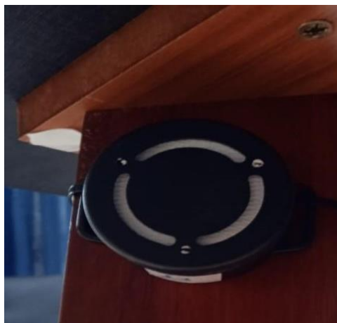
Figura 13- Câmara de detecção montada e instalada
