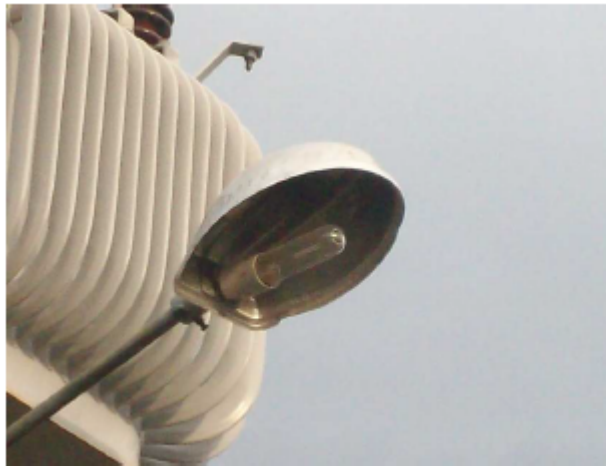
Figura 10 – Luminária inadequada para iluminação pública
