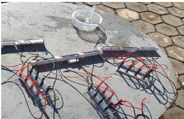
Figura 13 – Micro bomba de água funcionando por meio de energia solar.
