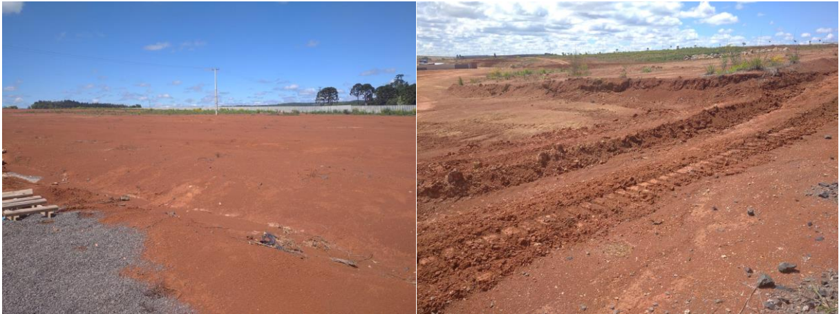
Figura 17 – Verificação de erosão e afloramentos rochosos (item 3)
