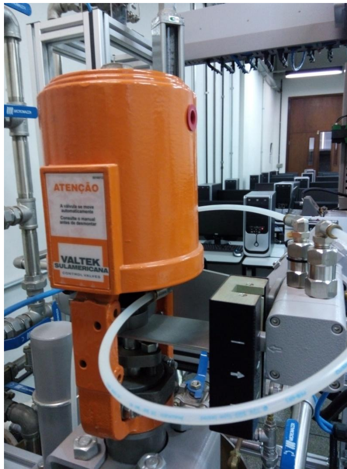
Figura 5: Válvula de controle do tipo Globo presente na Planta
