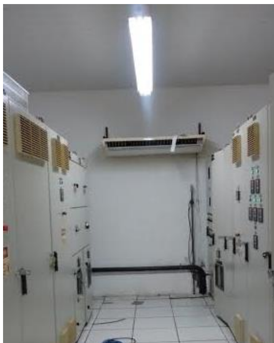
Figura 17 - Sala de comando Fonte: Autoria Própria.
