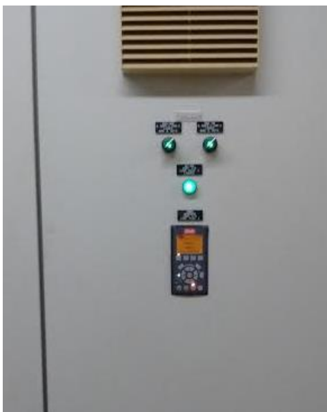
Figura 18 - Porta do painel Fonte: Aatoria própria
