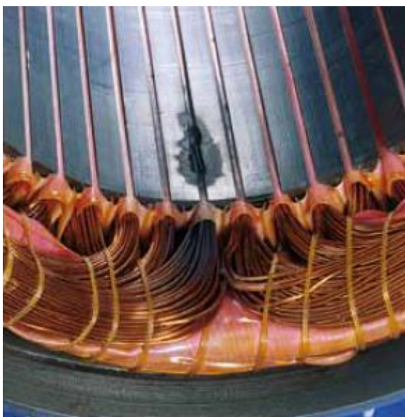
Figura 6 - Curto-circuito na ranhura Fonte - WEG, 2012.
