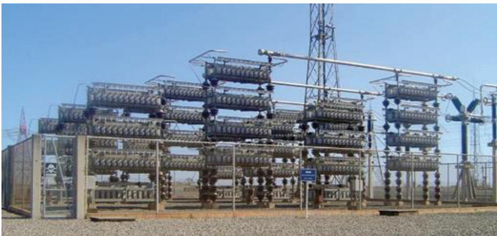
Figura 3 - Banco de Capacitores em derivação.
