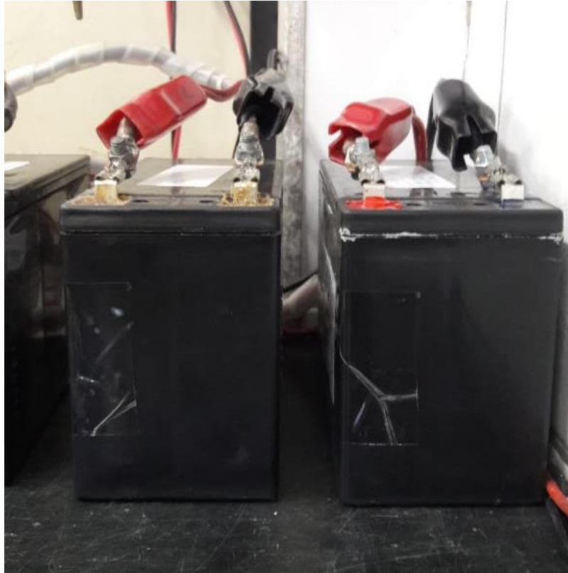
Figura 9 – Baterias de chumbo ácido do tipo VRLA conectadas a bancada
