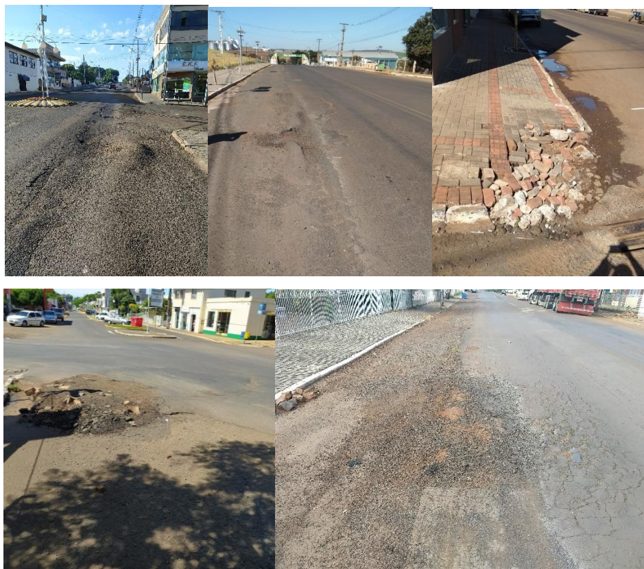
Figura 1 - Danos na zona central cidade de Itapejara D'Oeste-PR
