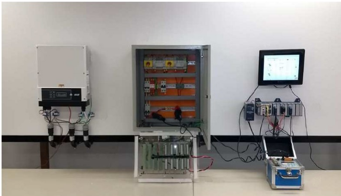
Figura 7 – Sistema de monitoramento e gerenciamento do sistema fotovoltaico.
