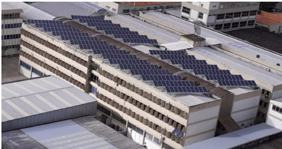
Figura 4 – Sistema fotovoltaico grid-tie instalado na UTFPR, câmpus Curitiba/Centro.
