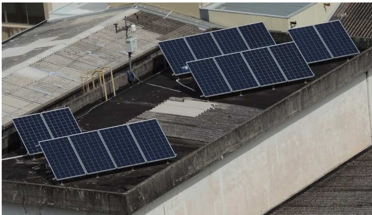
Figura 6 – Sistema solar fotovoltaico instalada na Universidade Tecnológica Federal do Paraná (UTFPR), na cidade de Curitiba/PR.
