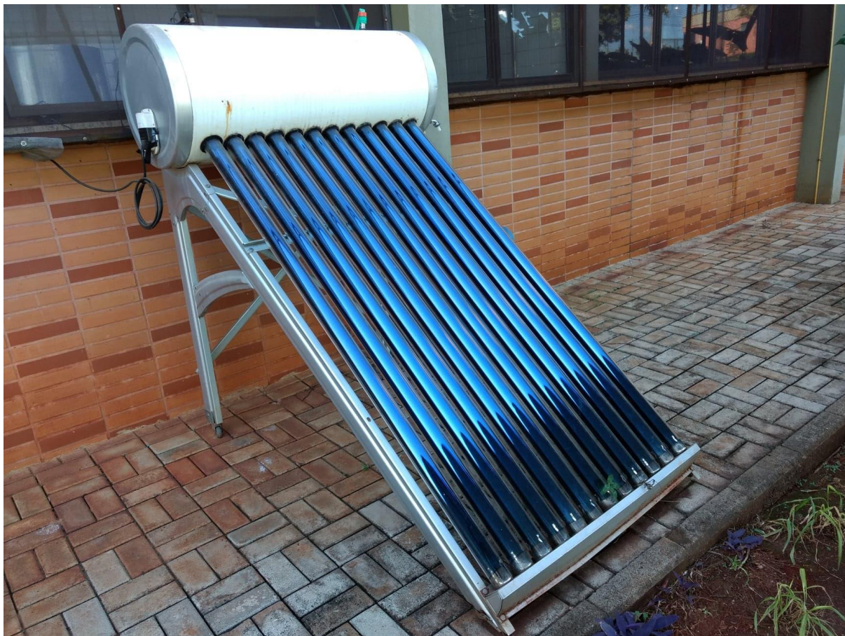
Figura 10 - Aquecedor de Água por Energia Solar Comercial
