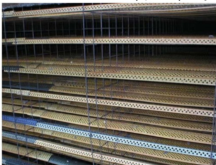
Figura 9 – Enchimento de uma torre de resfriamento limpo, livre da presença de biofilme
