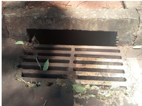
Figura 14 - Exemplo de boca de lobo
