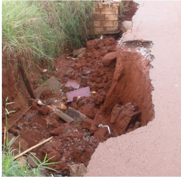
Figura 9 – Rua urbana que sofreu deslizamento do talude
