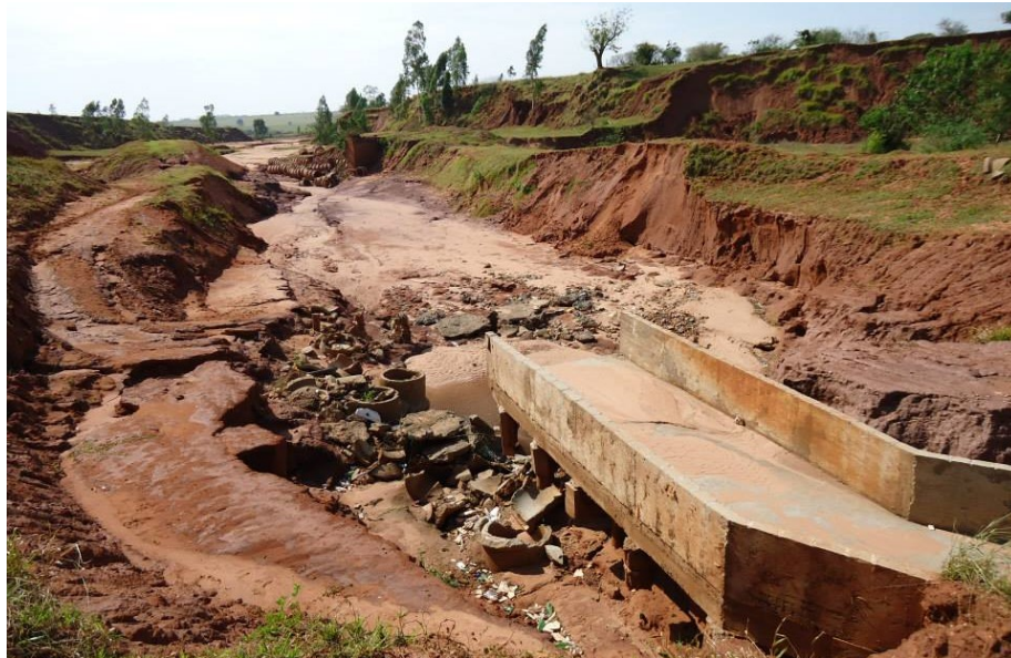
Figura 10 - Processo erosivo acentuado a jusante do emissário de águas pluviais
