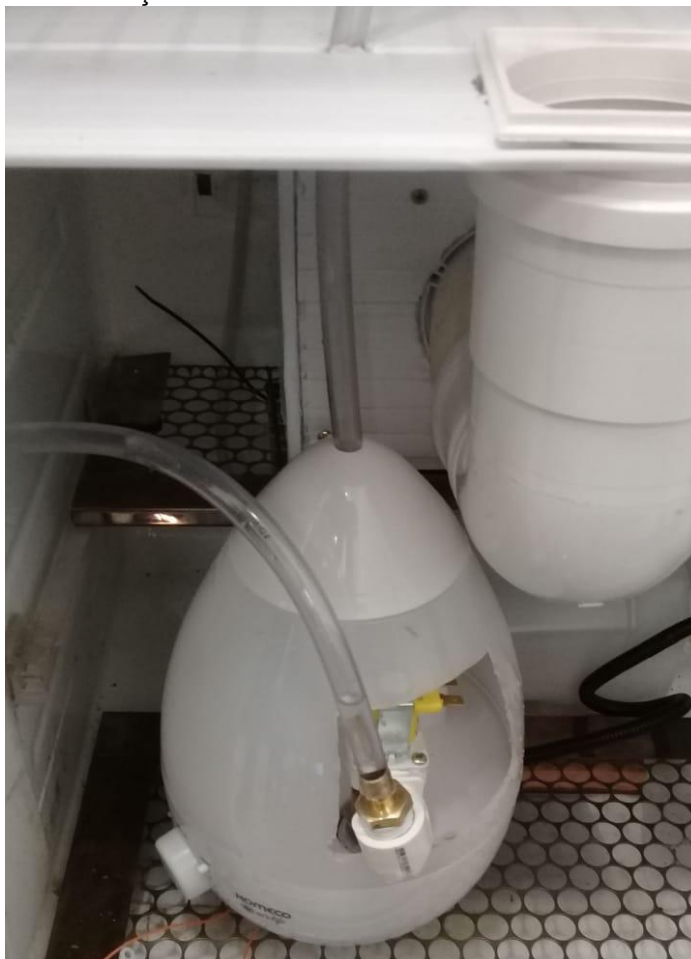
Figura 34 – Atuador de umidificação do ar.
