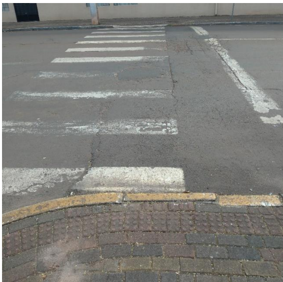
Figura 20 - Faixa de pedestre com pintura desgastada Fonte: Aatoria Própria, 2021.
