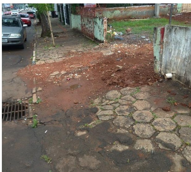
Figura 14 - Calçada fora da tipologia, bastante degradada, no Trecho 07 Fonte: Aatoria Própria, 2021.
