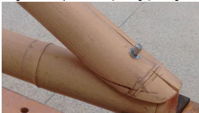
Figura 22 – Ruptura de treliça na ligação diagonal
