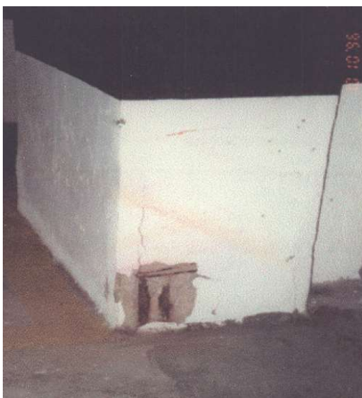
Figura 11: Corrosão da armadura no pé do pilar de concreto Fonte: Garcia (1999).
