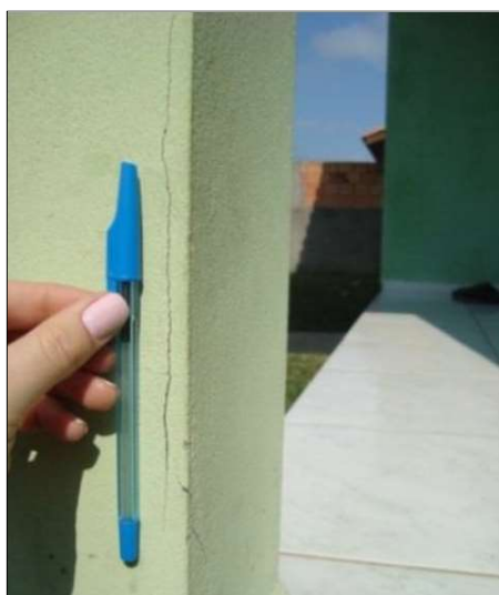
(a) Deslocamento do reboco
