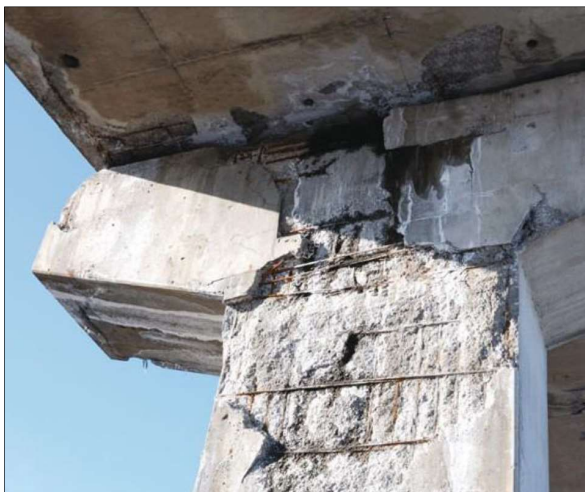
Figura 10: Desagregação de uma estrutura de concreto Fonte: Portal Metálica Construção Civil (2017) apud Freisleben (2017).
