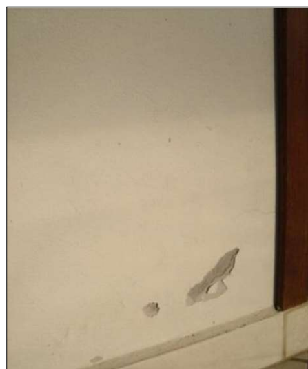
(b) Descolamento do reboco
