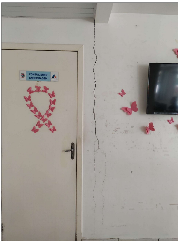
Figura 28: Trinca vertical próxima ao apoio Fonte: Autoria própria (2021).
