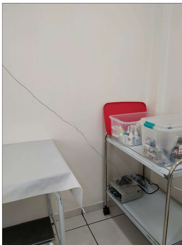
Figura 23: Fissura inclinada 45° na parede Fonte: Autoria própria (2021).
