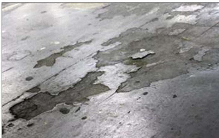
Figura 9: Desgaste em um piso de concreto Fonte: Husqvarna (2013) apud Freisleben (2017).
