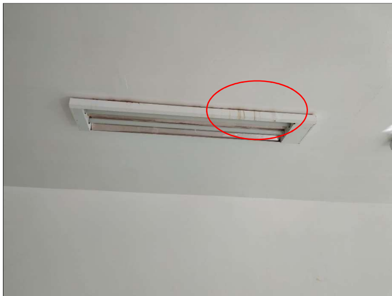
Figura 19: Infiltração pela laje de cobertura próxima a rede elétrica Fonte: Autoria própria (2021).
