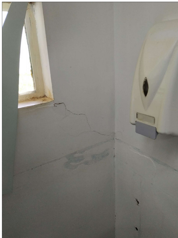
Figura 21: Fissura em 45° na janela Fonte: Autoria própria (2021).
