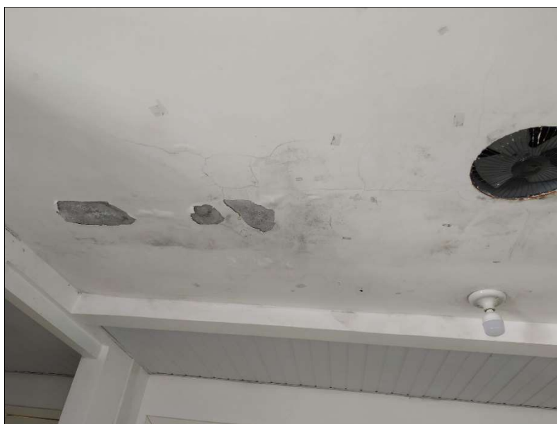
Figura 18: Infiltração pela laje de cobertura Fonte: Autoria própria (2021).
