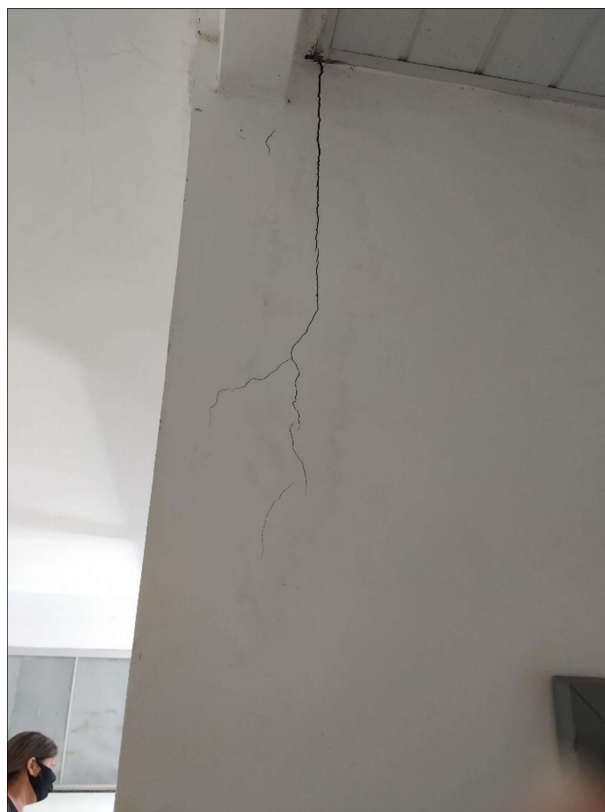
Figura 27: Trinca vertical junto ao apoio Fonte: Autoria própria (2021).
