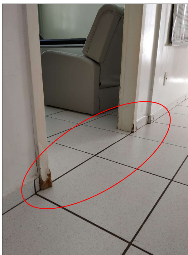
Figura 16: Deterioração do batente da porta de madeira Fonte: Autoria própria (2021).
