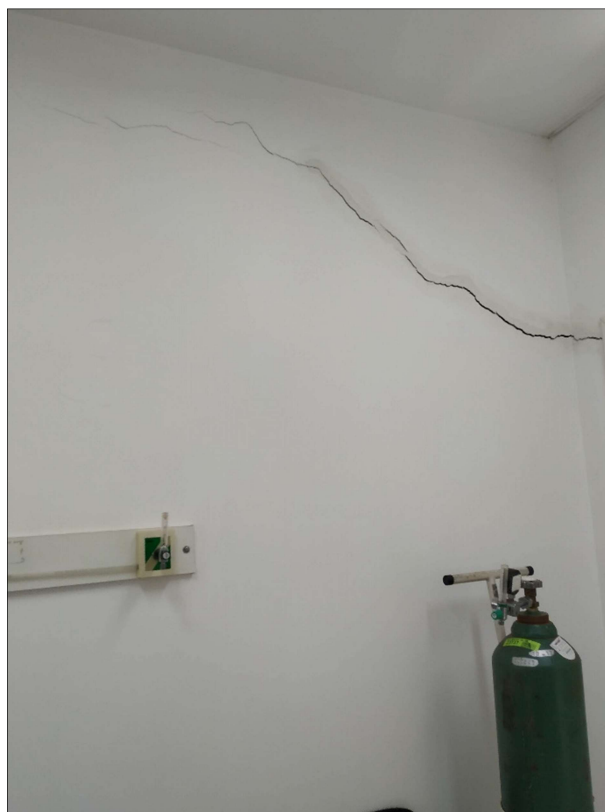
Figura 24: Rachadura inclinada 45° na parede Fonte: Autoria própria (2021).
