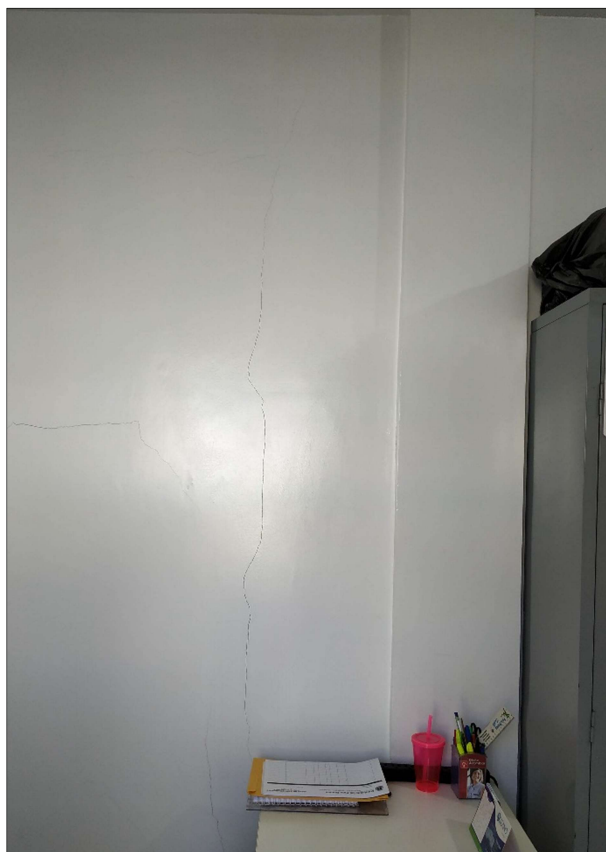
Figura 25: Fissura vertical no centro da parede Fonte: Autoria própria (2021).
