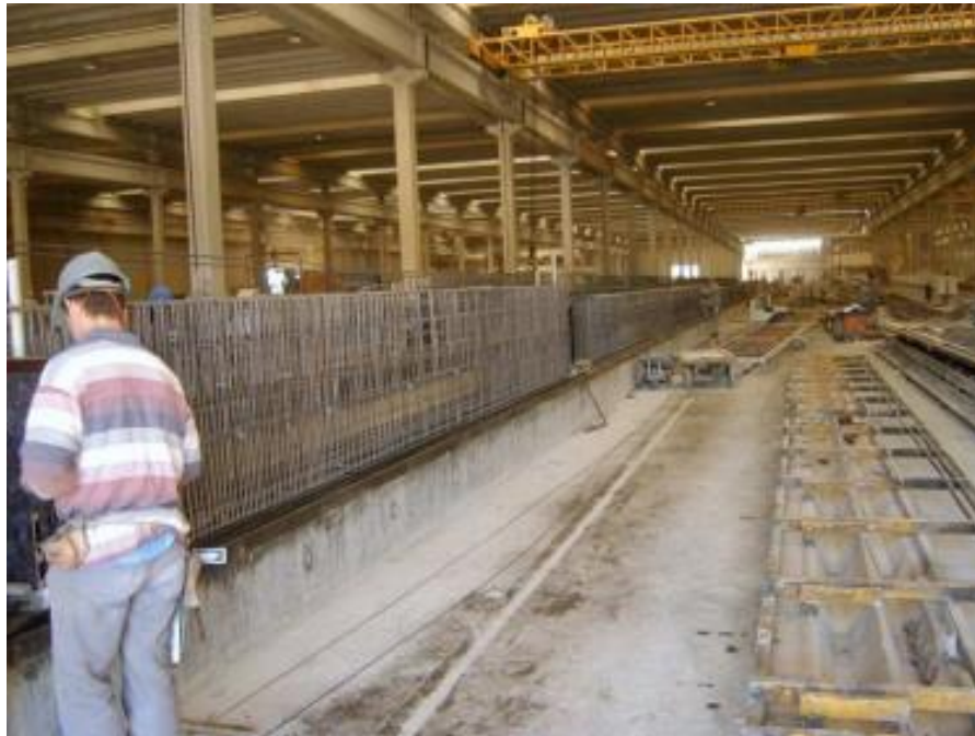
Figura 18: Central de armação Fonte: Associação Brasileira de Construção Industrializada de Concreto, 2013.
