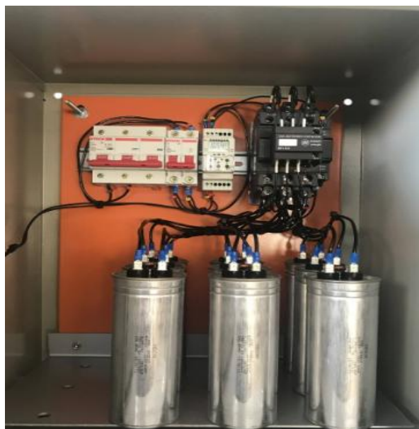
Figura 10: Banco de Capacitores montado pelo fabricante Engerey
