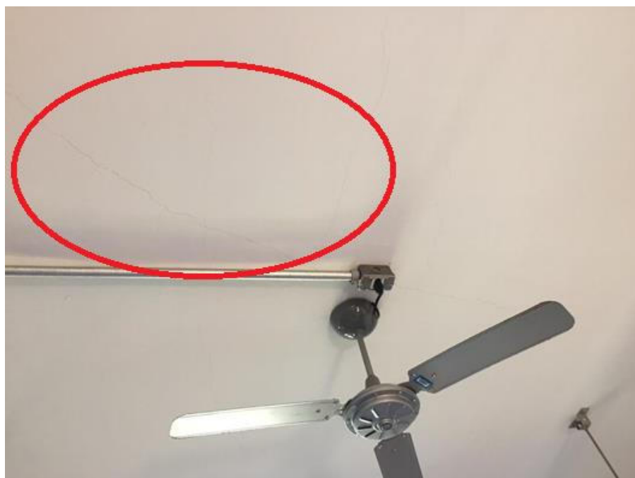
Figura 31 – Fissuras na face inferior da laje com abertura de aproximadamente 0,5 mm
