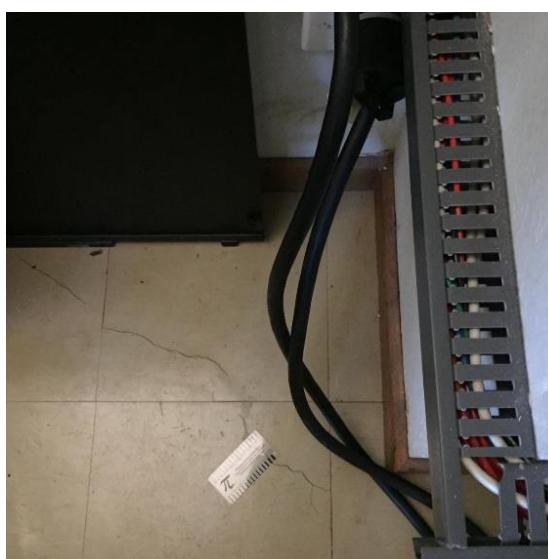
Figura 25 – Trincas inclinadas na sala A-202 com abertura de 1,0 mm
