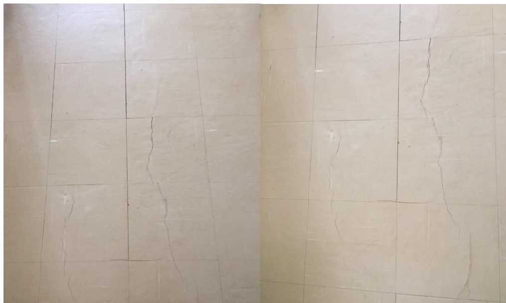
Figura 28 – Trincas na sala A-203 com abertura de 1,0 mm
