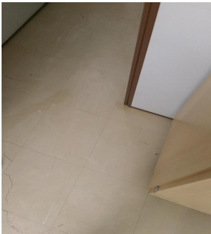
Figura 29 – Água escorrendo para o ponto mais fundo
