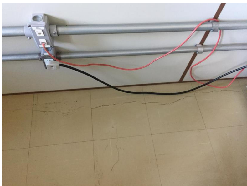
Figura 37 – Trinca no canto da sala A-206 com abertura de 1,0 mm
