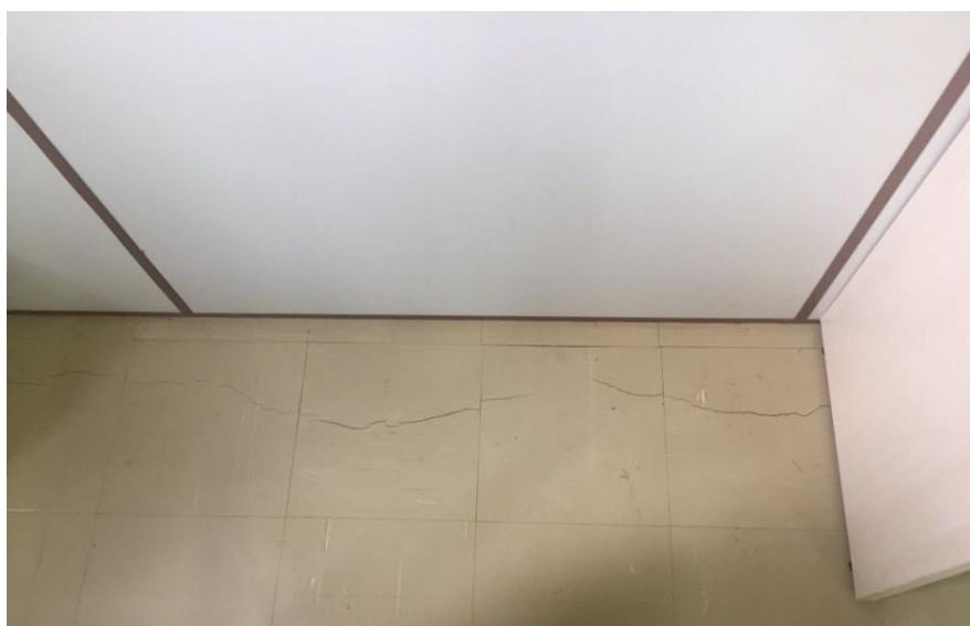
Figura 33 – Trinca nos cantos da laje da sala A-205 com abertura de 1,0 mm
