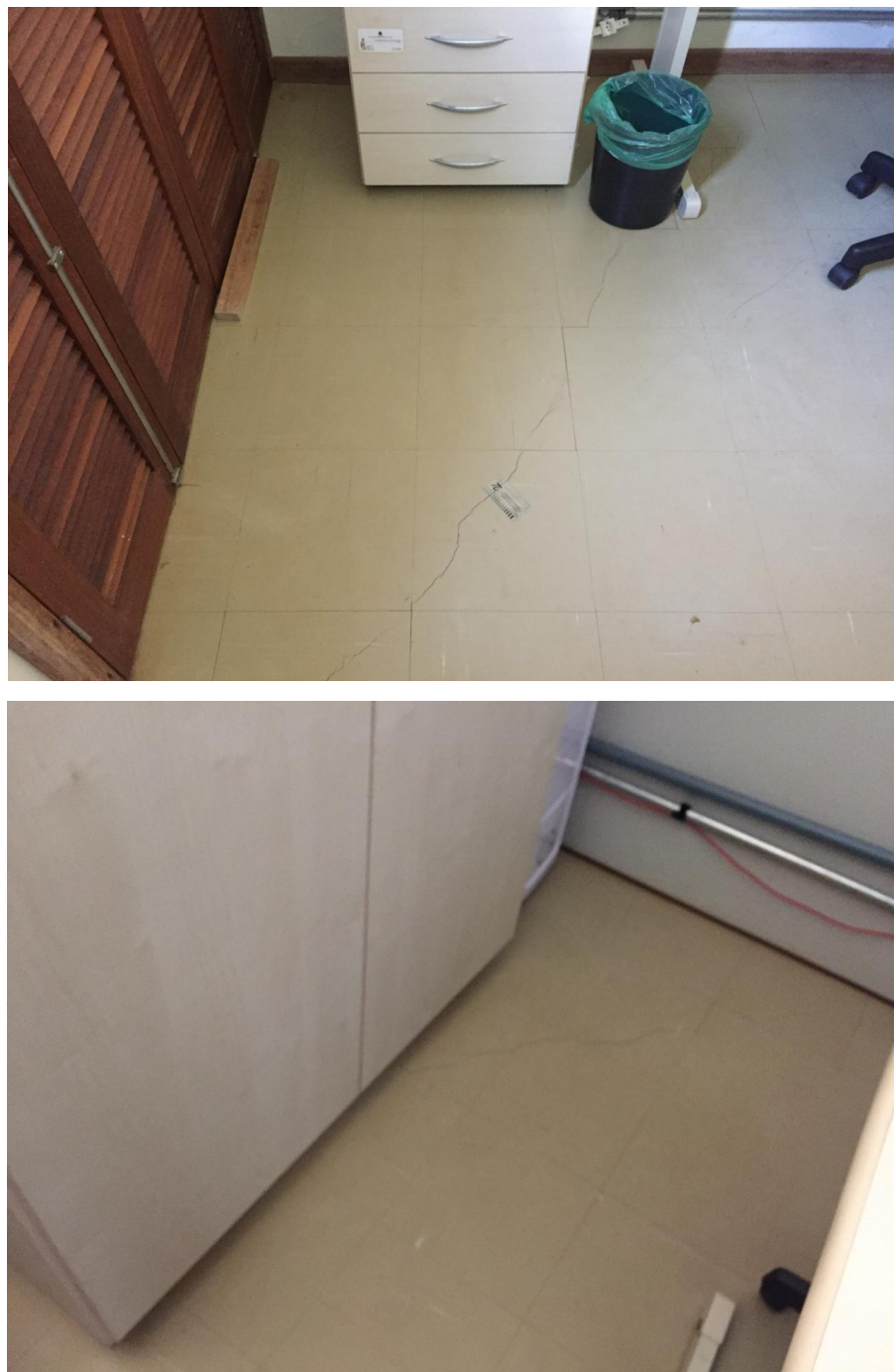
Figura 41 – Trincas inclinadas nos cantos da sala A-207 com abertura de 1,0 mm
