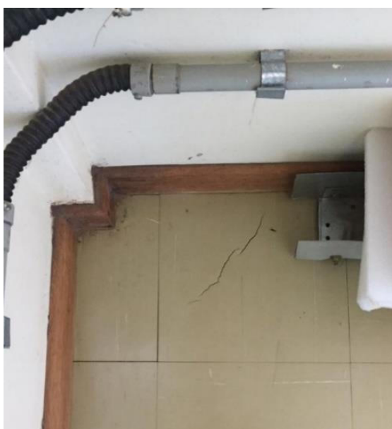
Figura 24 – Trincas inclinadas na sala A-202 com abertura de 0,6 mm
