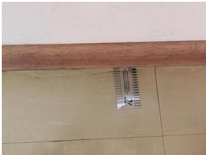
Figura 26 – Trinca no canto da laje da sala A-202 com abertura de 0,75 mm
