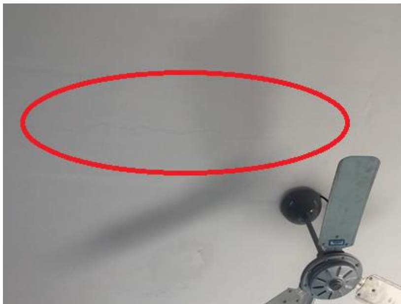
Figura 42 – Fissuras na face inferior da laje com abertura de aproximadamente 0,5 mm
