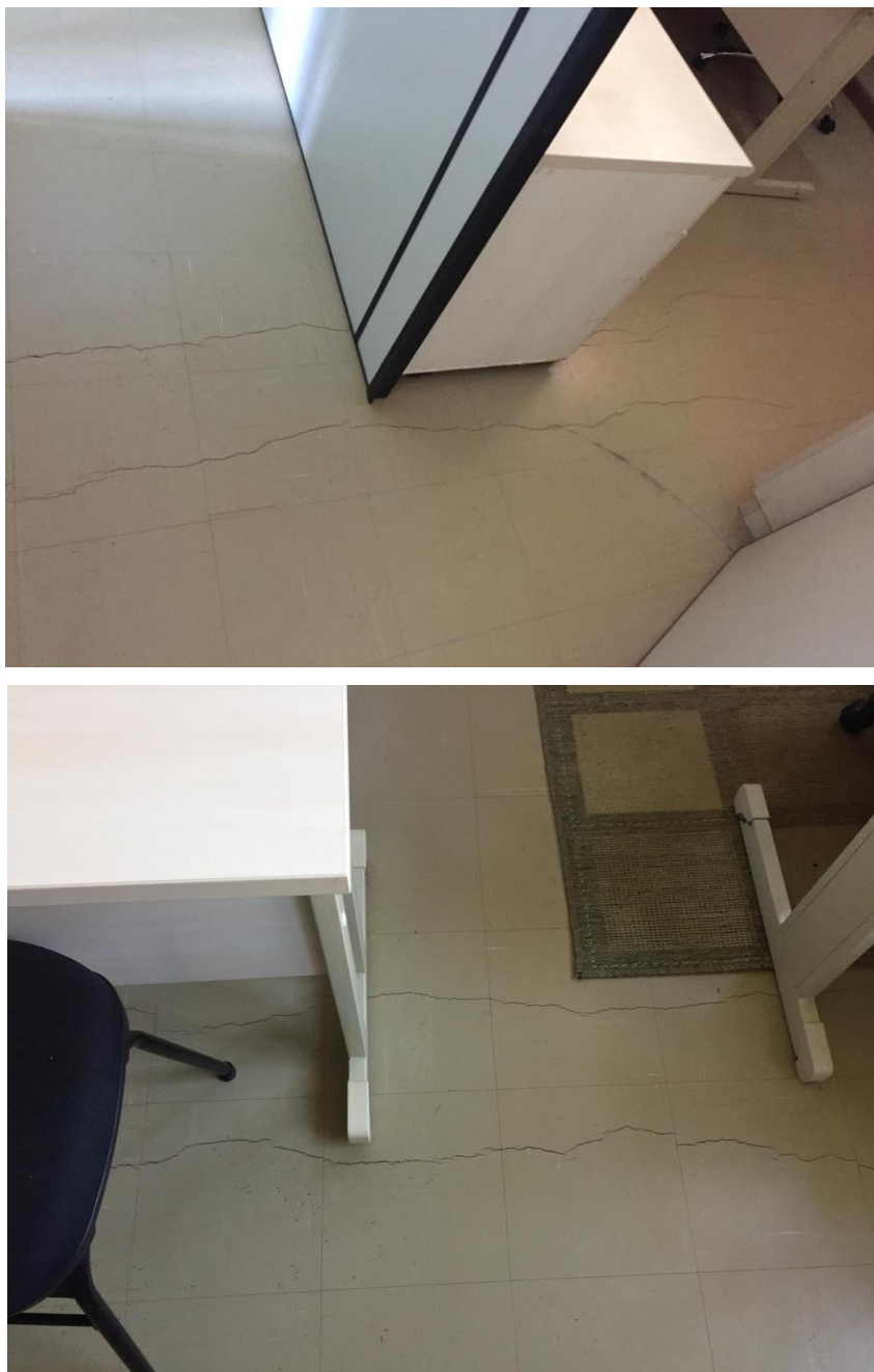
Figura 40 – Trinca de grande extensão e abertura de 1,4 mm na sala A-207
