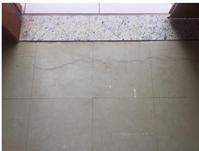
Figura 27 – Trinca na entrada da sala A-203 com abertura de 0,7 mm
