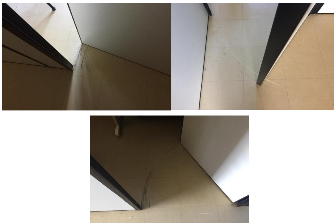
Figura 43 – Marcas das portas no chão da sala A-207
