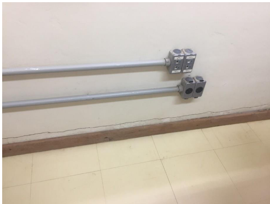
Figura 34 – Trincas extensas na parede da sala A-205 com abertura de 1,4 mm
