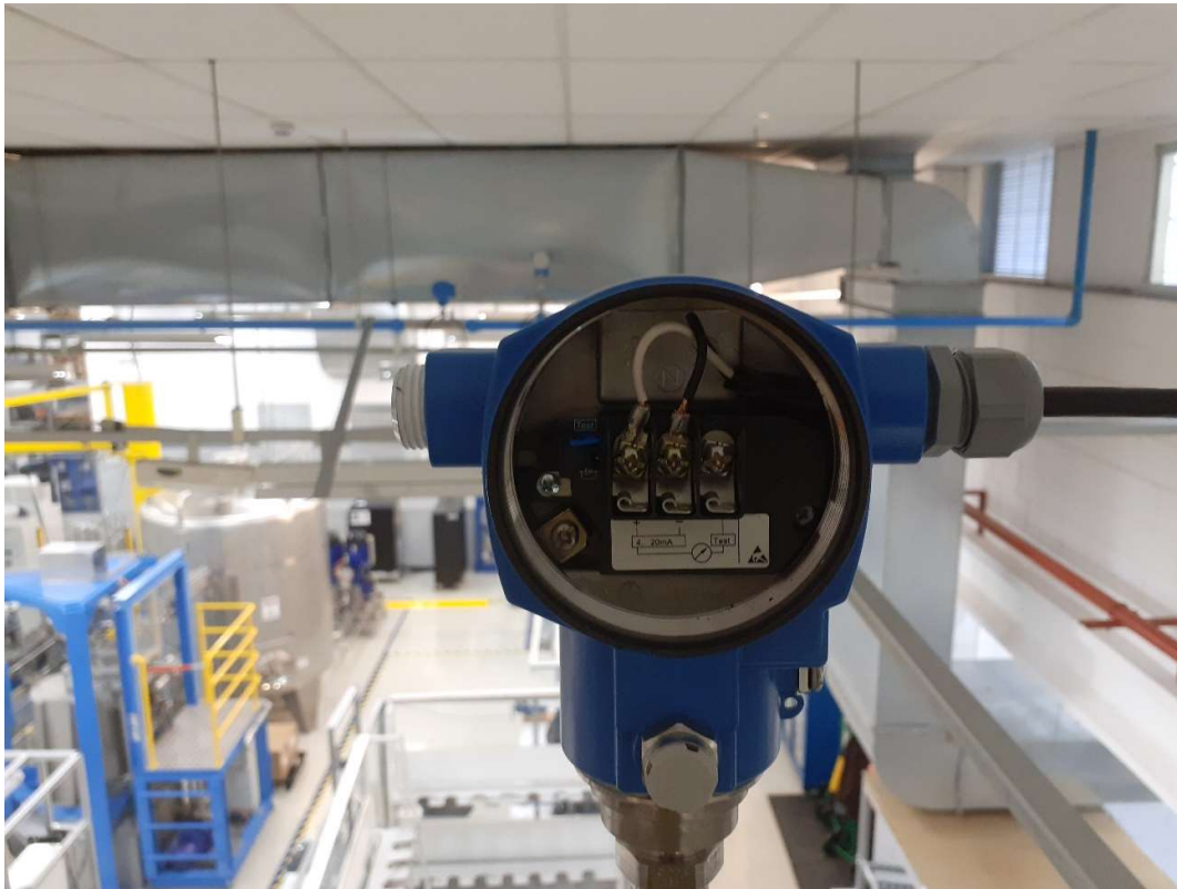
Figura 9 – Medidor de pressão com sua conexão elétrica e comunicação Fonte: Autoria própria
