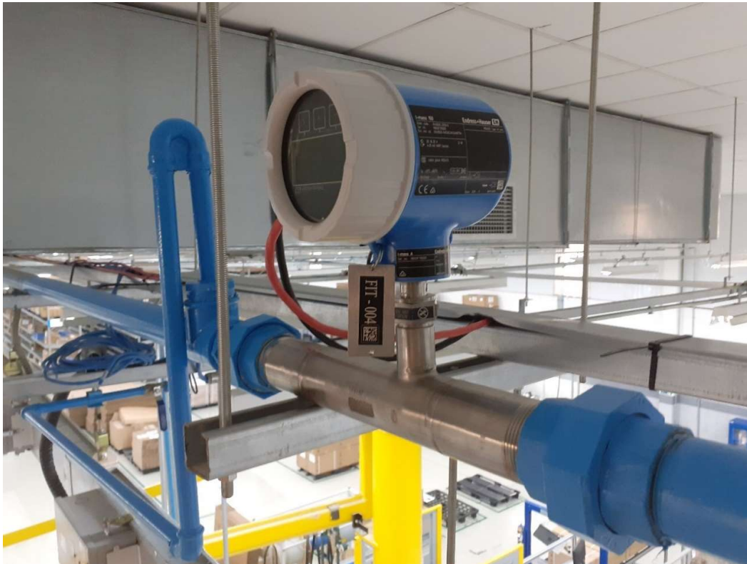
Figura 8 – Medidor de vazão instalado na linha de ar comprimido Fonte: Autoria própria
