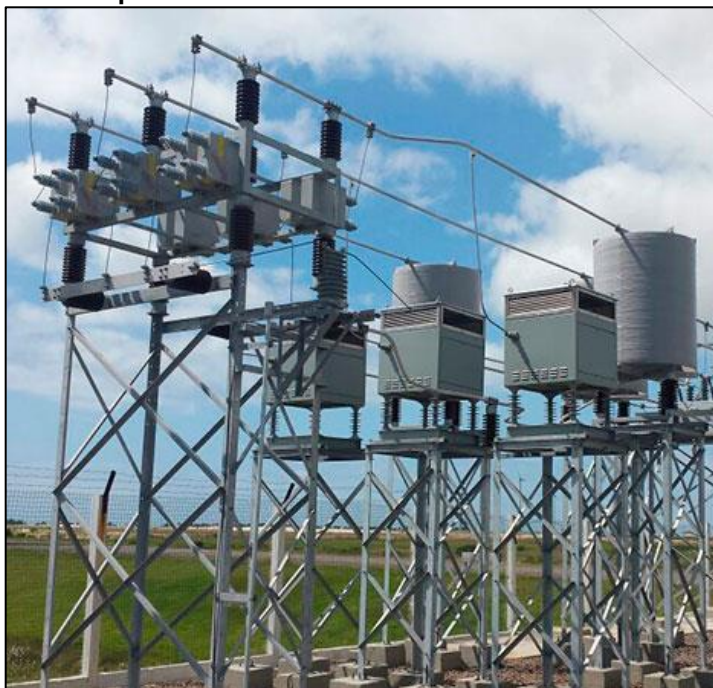
Figura 15 - Exemplar Real de Filtros Passivos Passa-Alta ou Amortecido
