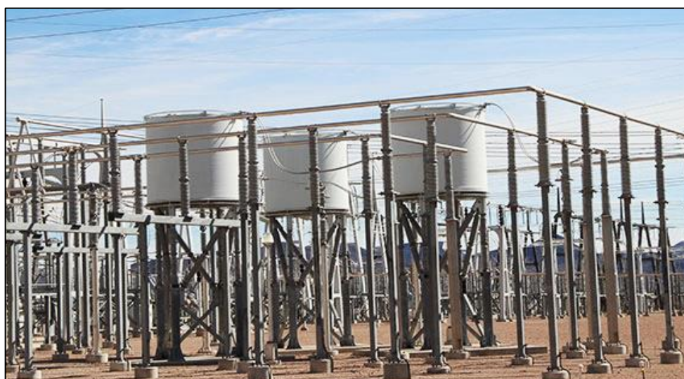
Figura 11 - Banco de Reatores (indutores de dessintonia)
