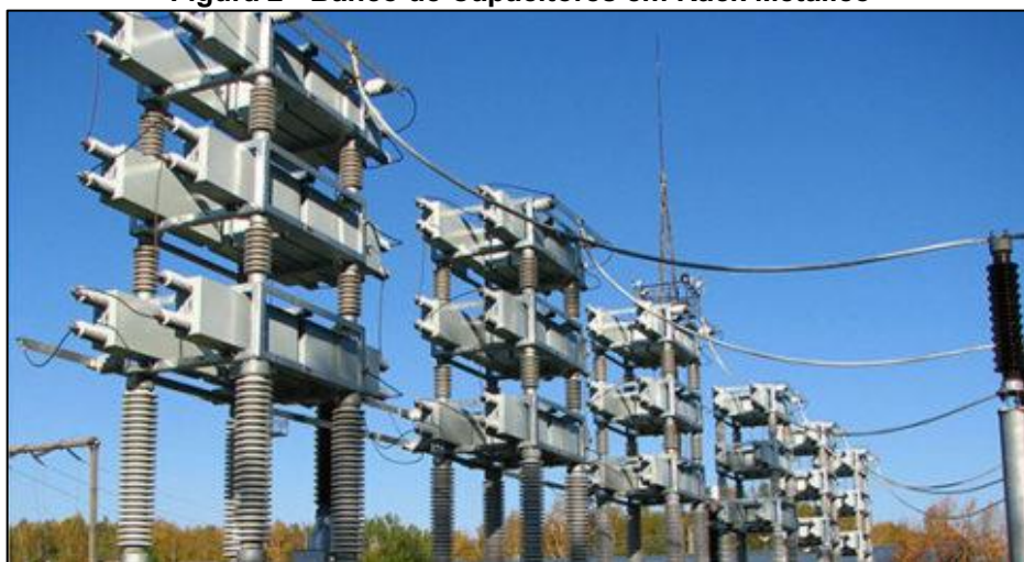
Figura 2 - Banco de Capacitores em Rack Metálico
