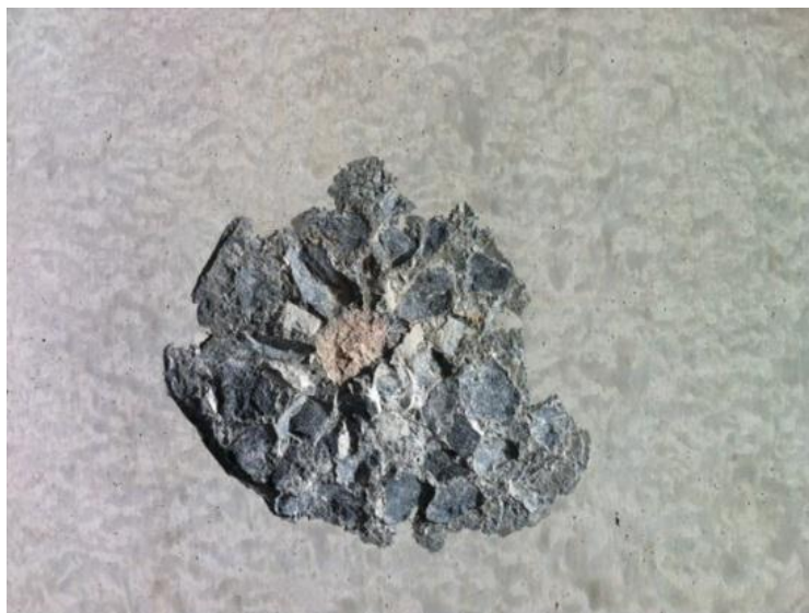
Figura 43 - Agregado graúdo com contaminação, ocasionando a expulsão do concreto seco Fonte: Autora.
