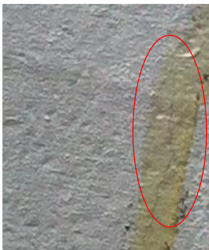
Figura 44 - Fissura no concreto, ocasionada pela utilização do cimento indicado inadequadamente pelo fornecedor Fonte: Autora.
