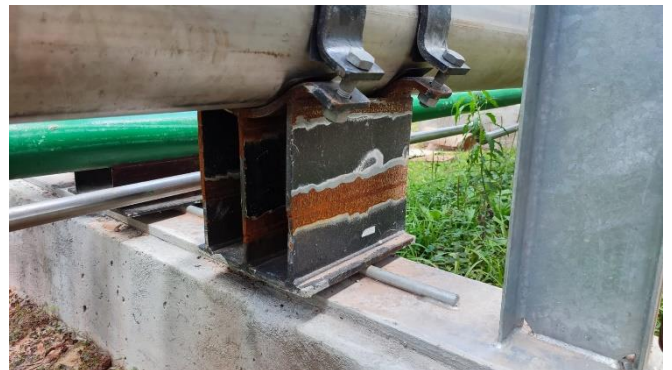
Foto 10: Cordão de solda sem reforço, junta de topo em suporte de tubulação, feita em ER.
