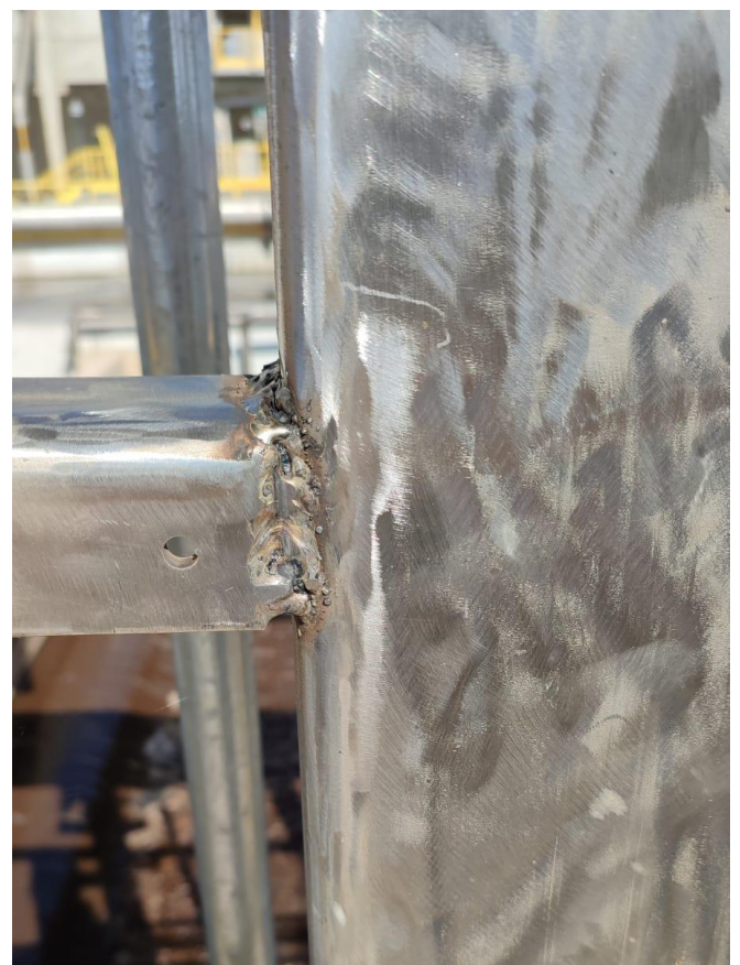
Foto 8: Solda em contorno, perfil L. Porosidades, falta de fusão, mordedura.
