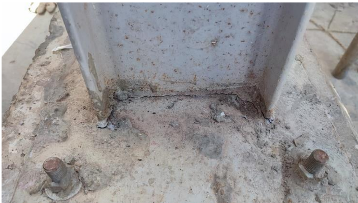
Fotografia 1 – Fratura no cordão de solda
