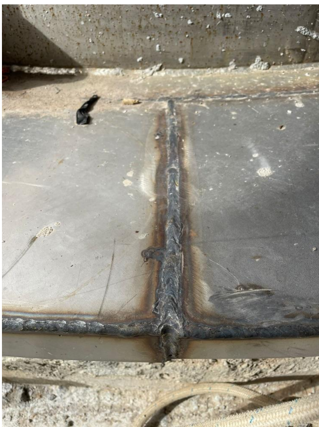
Foto 7: Solda em base de inox para um tanque de água desmineralizada, processo TIG
