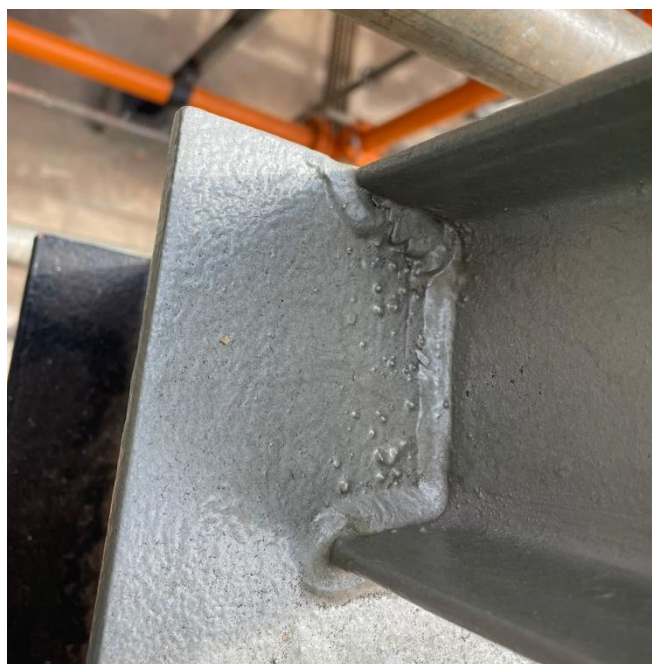
Foto 3: Suporte em perfil U e chapa grossa, soldado em MAG. Altura do reforço insuficiente, respingos.
