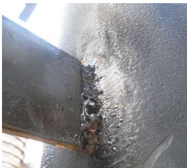
Foto 1: Suporte estrutural em perfil L, soldado em ER. Cordão irregular, falta de fusão, porosidades.
