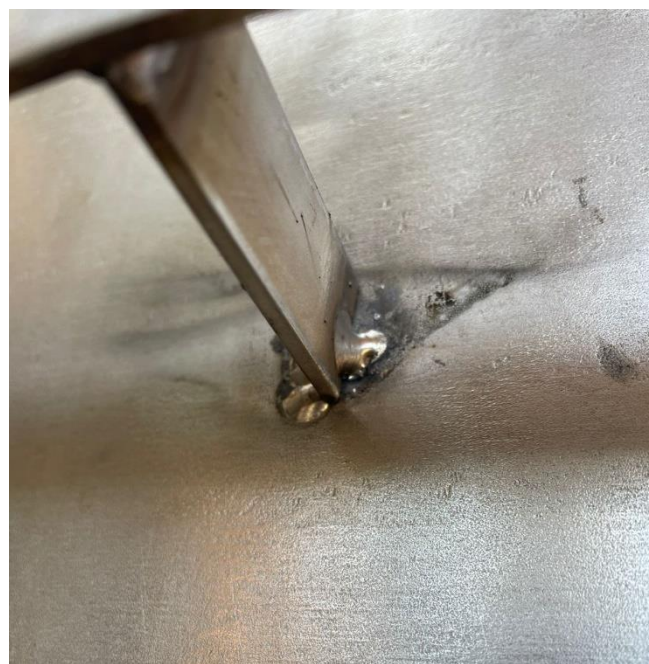
Foto 4: Solda filete TIG em suporte de travamento na tubulação de inox. Filete contínuo não executado conforme
