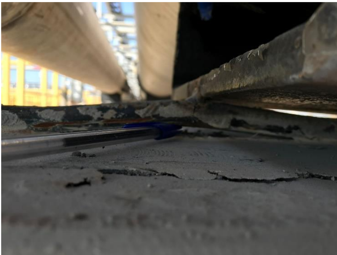
Fotografia 2 – Ponto de solda irregular, com distorção de peça
