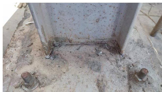
Foto 9: Falha do cordão de solda em estrutura para tubulações, em ER devido a presença de trincas.
