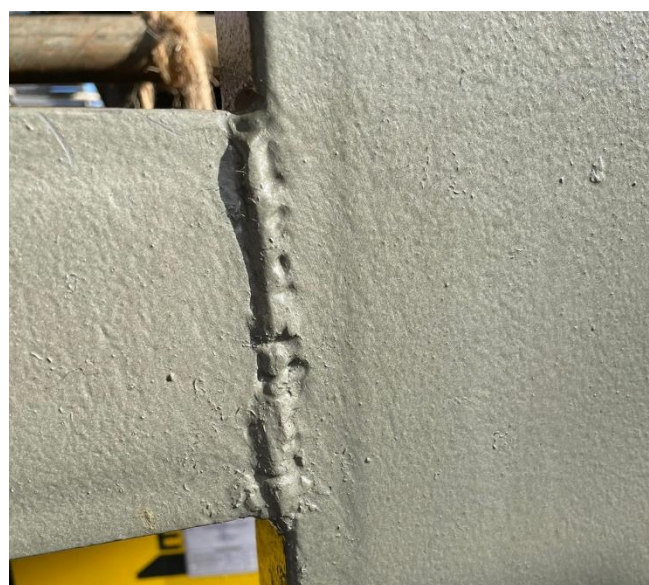
Foto 2: Suporte estrutural em perfil U, soldado em ER e pintado. Cordão irregular, falta de fusão, mordedura
