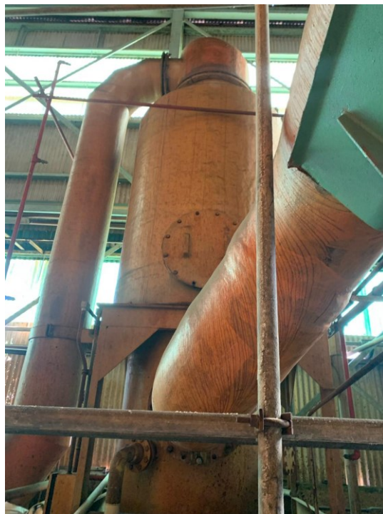
Figura 11 – Torre de lavagem de gases da empresa.
