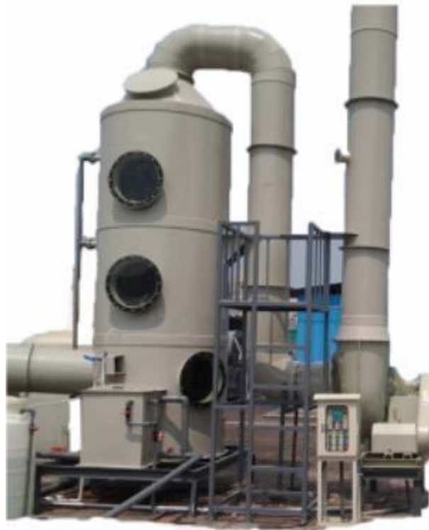
Figura 50 - Torre de absorção
