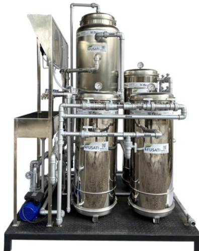
Figura 43 - Estação de tratamento de água
