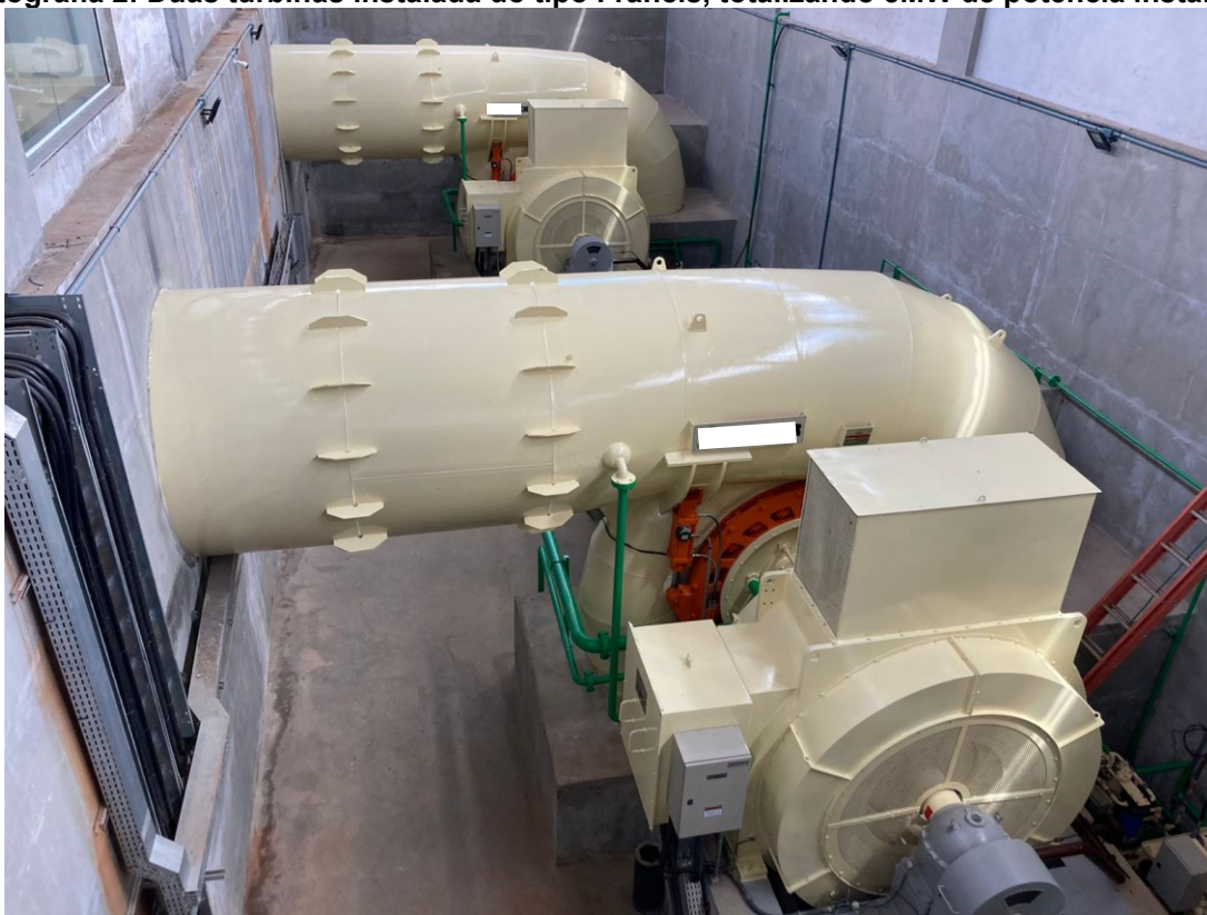
Fotografia 2: Duas turbinas instalada do tipo Francis, totalizando 5MW de potência instalada
