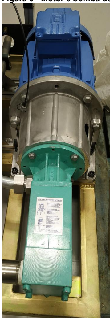
Figura 3 - Motor e bomba de alta pressão
