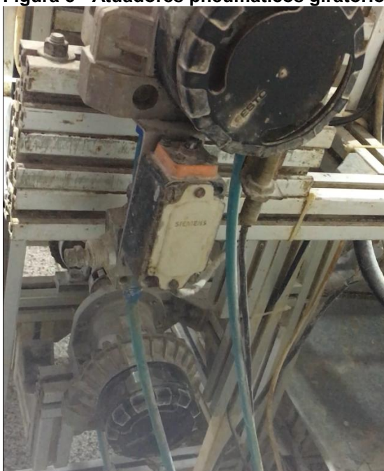
Figura 5 - Atuadores pneumáticos giratórios antes do retrofit
