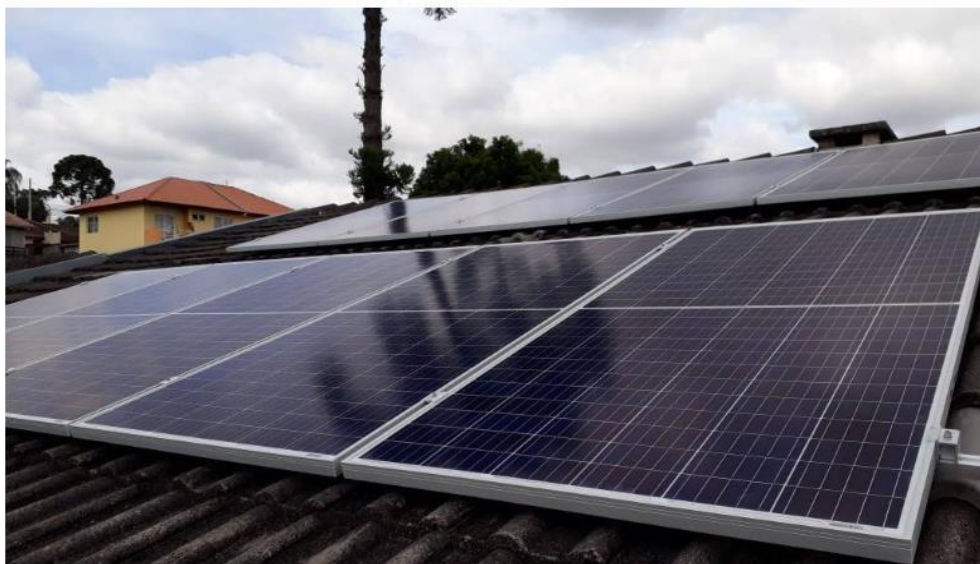
Figura 19 - Módulos Fotovoltaicos - vista frontal - Sistema 2
