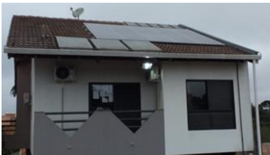
Figura 65 - Painel fotovoltaico instalado a face oeste
