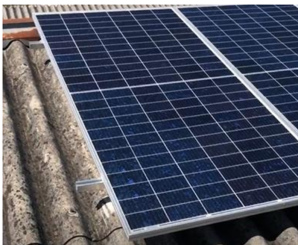
Figura 27 - Módulos Fotovoltaicos - vista frontal - Sistema 2
