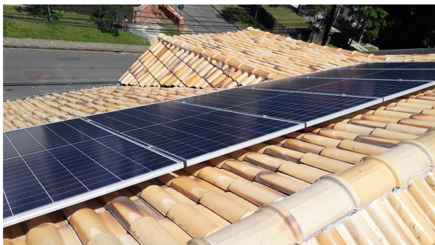
Figura 35 - Módulos instalados na face oeste
