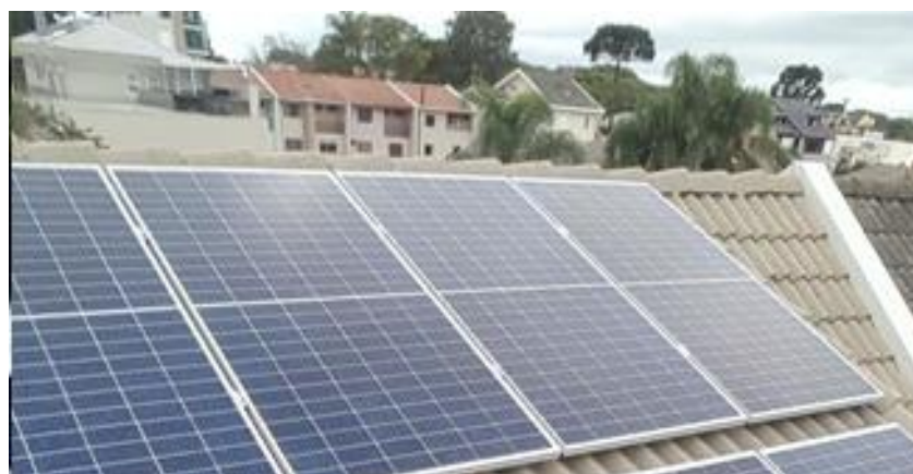
Figura 43 - Vista Frontal do painel fotovoltaico
