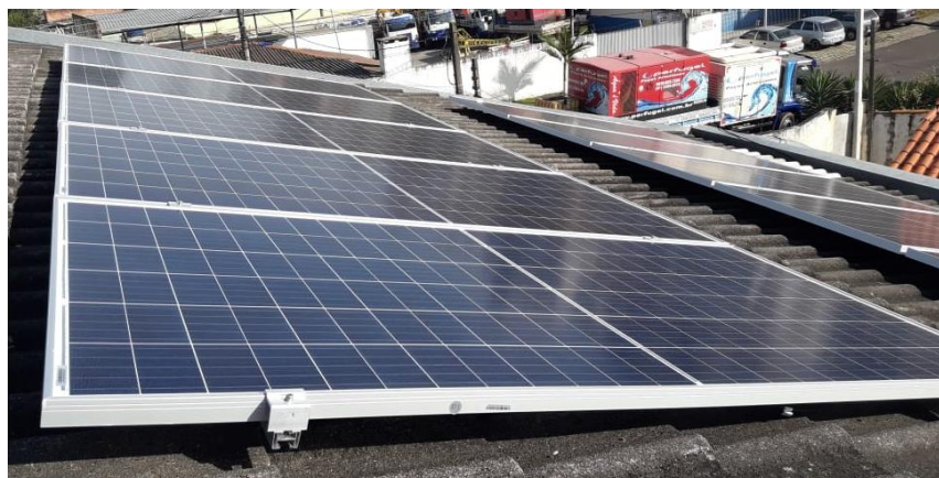
Figura 20 - Módulos Fotovoltaicos - vista posterior - Sistema 1
