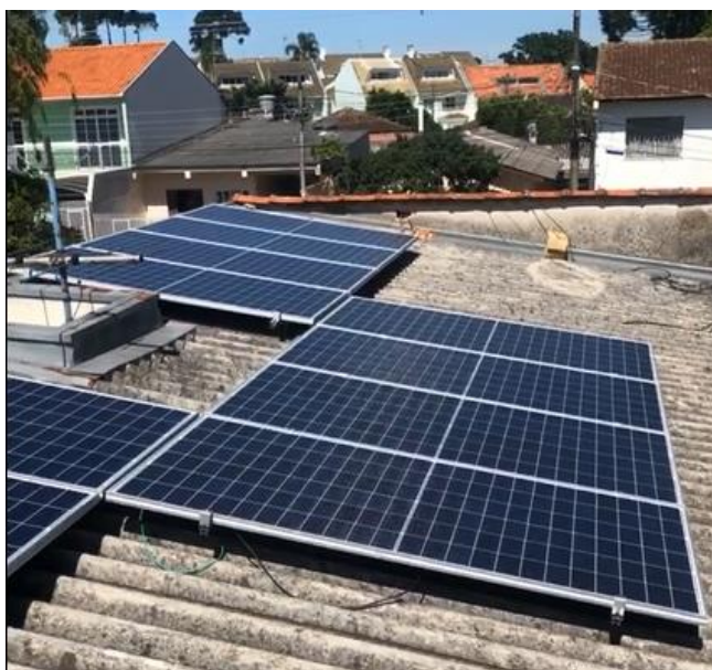
Figura 26 - Módulos Fotovoltaicos - vista lateral - Sistema 2
