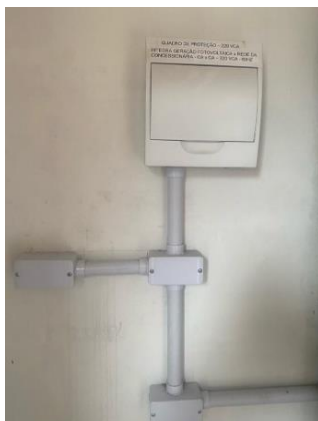
Figura 29 - Quadro de proteção CA - QDCA
