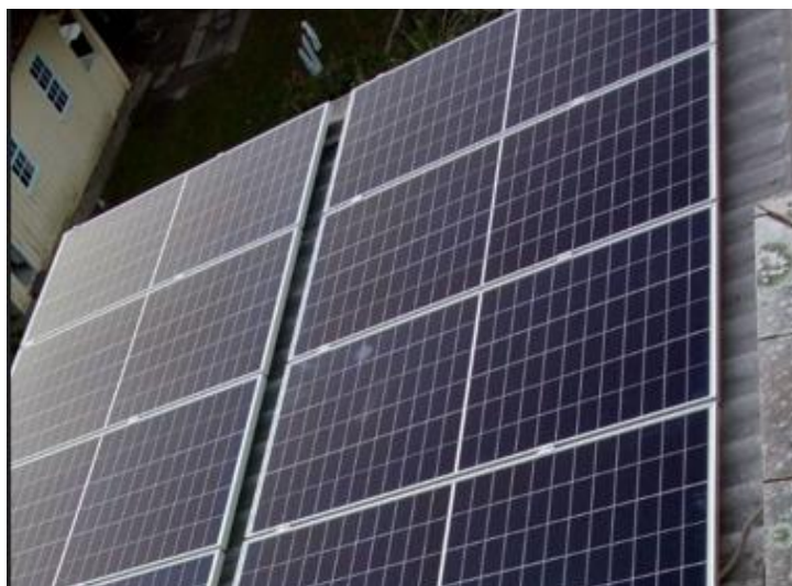
Figura 51 - Módulos instalados no telhado metálico
