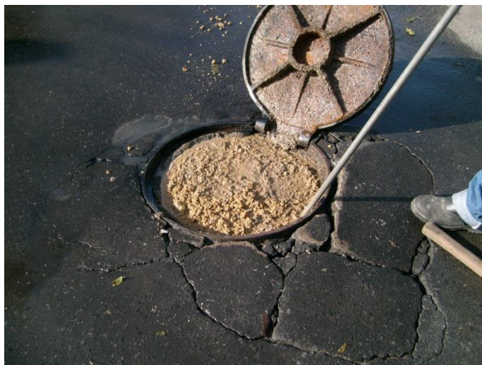
Figura 03 – Incrustação de gordura em poços de visita
