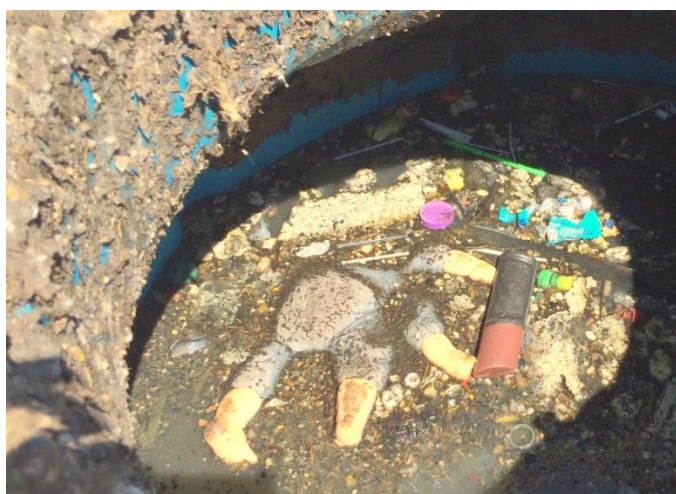
Figura 02 – Objetos encontrados em rede de esgoto obstruída
