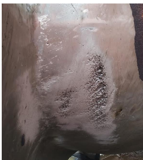
Figura 15 - Superfície afetada por erosão por cavitação.
