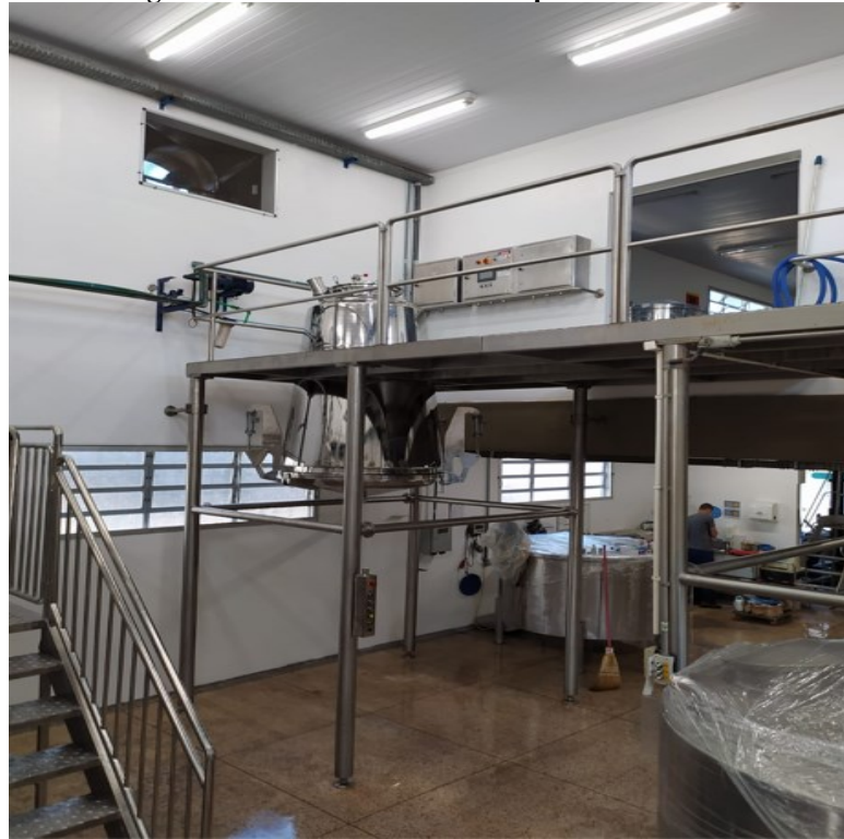
Figura 55 – Sistema instalado na planta industrial
