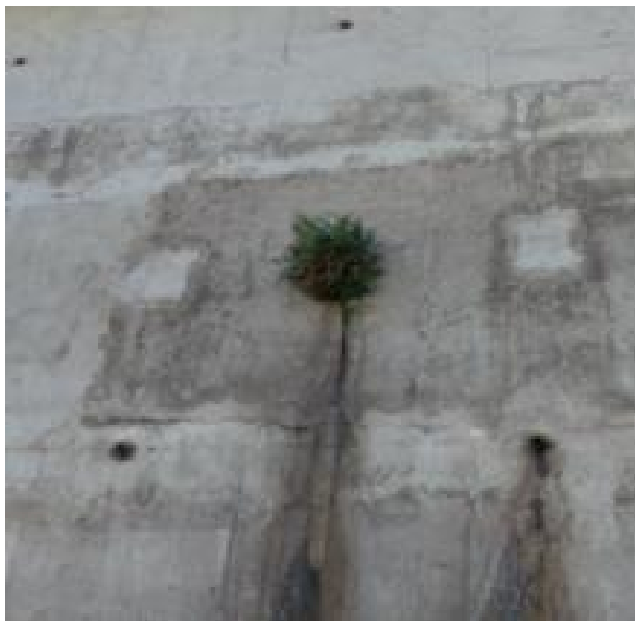
Figura 9 - Dreno barbacã inoperante
