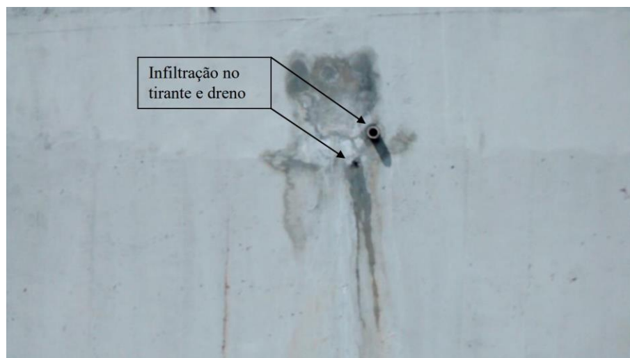
Figura 11 - Infiltração em Dreno Barbacã
