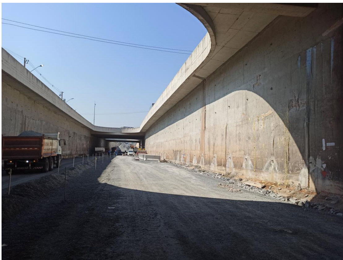
Figura 6 - Contenção com aspecto agressivo.
