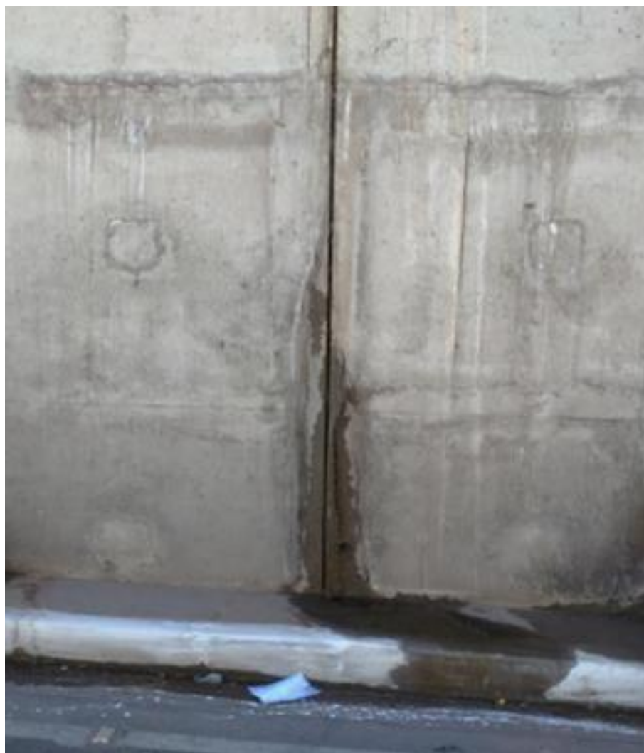
Figura 10: Juntas de Dilatação Danificadas
