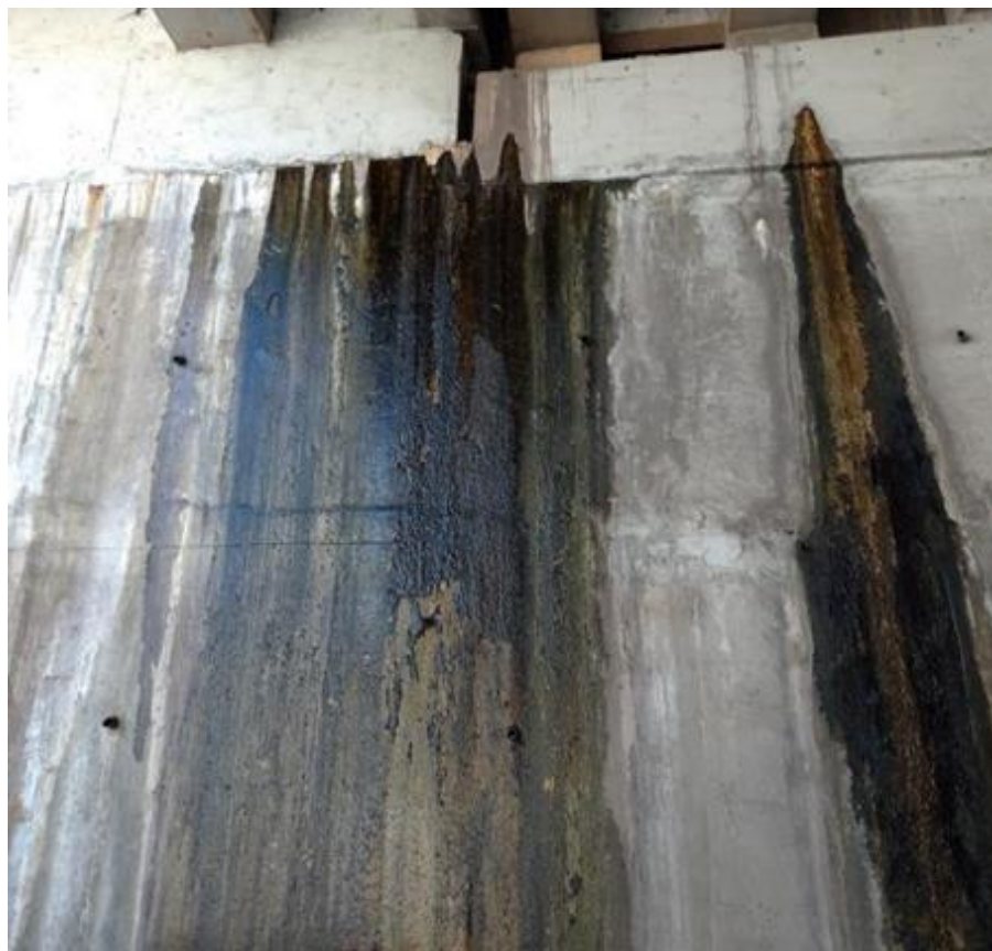
Figura 7 - Junta Fria de concreto
