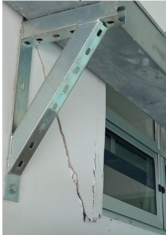
Figura 9: Trinca lateral esquadria Bloco V - Anomalia 02
