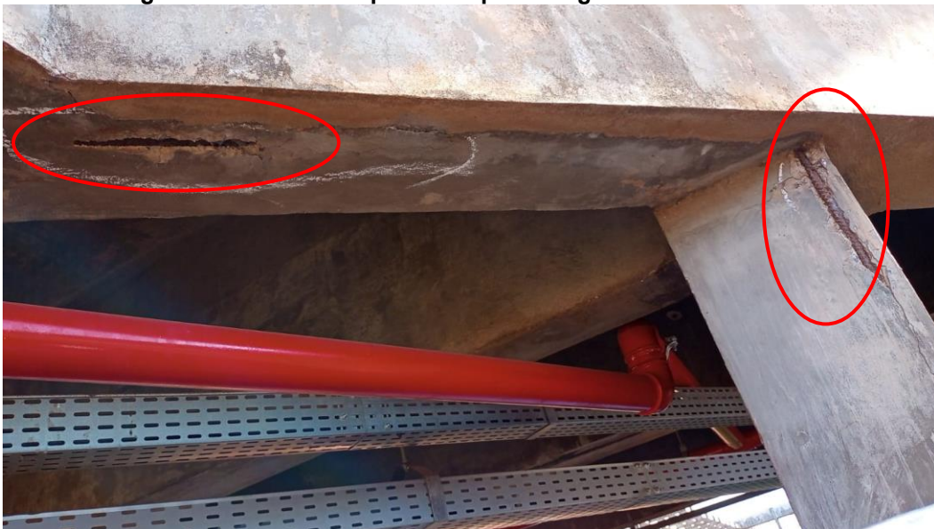
Figura 4: Armadura exposta em pilar e viga Bloco B – Anomalia 31
