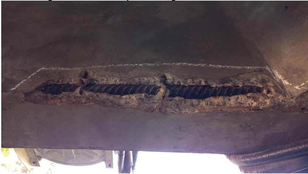
Figura 5: Armadura exposta em viga Bloco B – Anomalia 17
