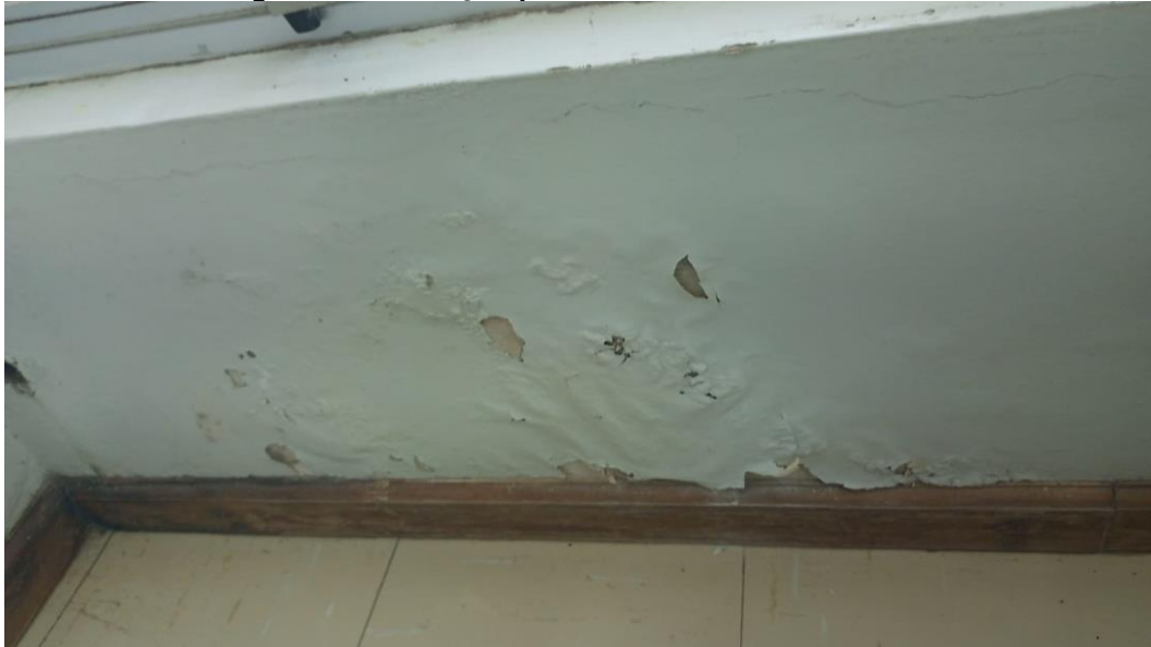
Figura 12: Infiltração parede Bloco Q – Anomalia 12
