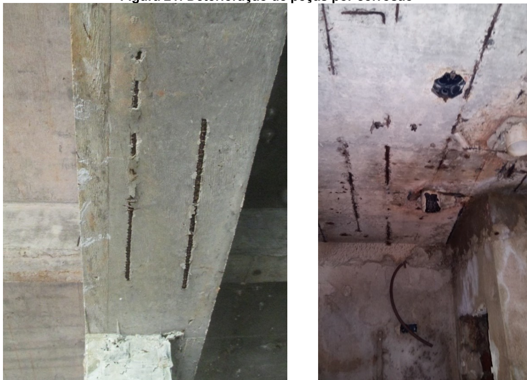
(a) Viga com armadura exposta a corrosão
