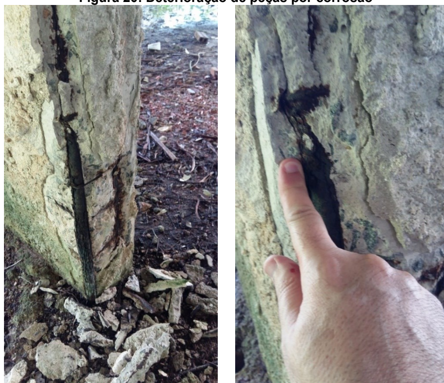
(a) Pilar com armaduras expostas a corrosão (b) Vista do cobrimento dos pilares na base
