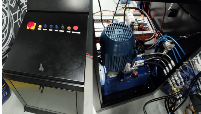
Figura 37 - Mesa de comando instalada
