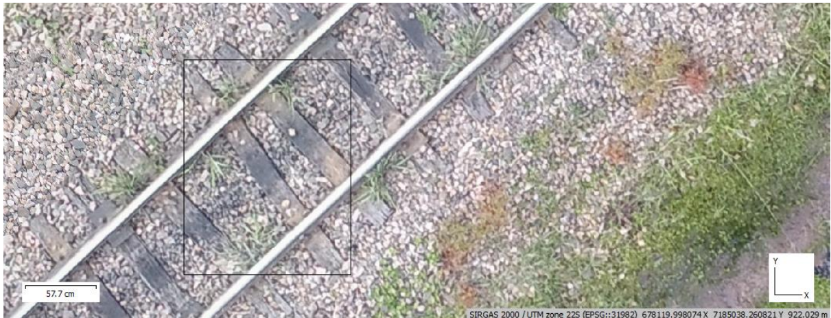
Figura 55 - Dormente apresentando escorregamento e esmoamento
