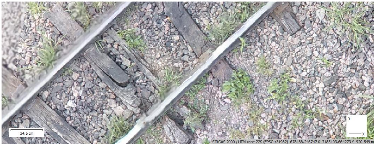
Figura 44 - Dormente em estado crítico
