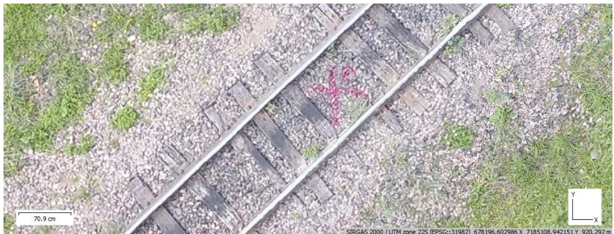
Figura 43 - Trecho com ausência de dormentes
