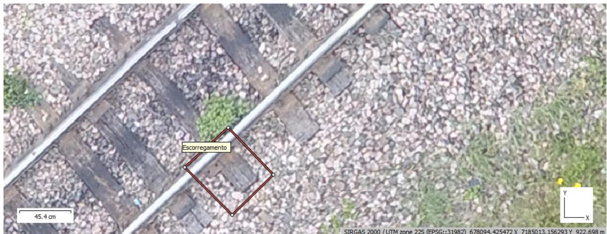
Figura 54 - Dormente apresentando escorregamento e falta de fixadores
