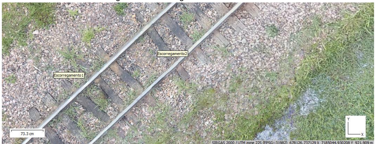
Figura 56 - Escorregamentos de dormentes
