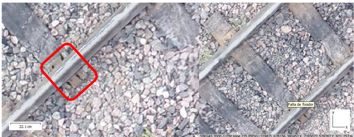
Figura 53 - Falta de fixadores
