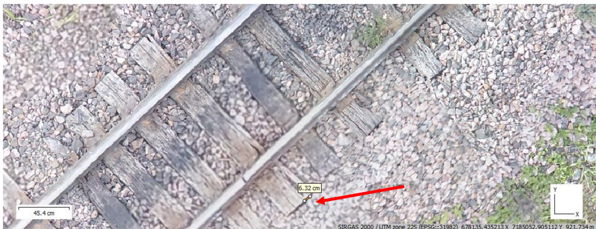
Figura 49 - Fendilhamento ultrapassando zonas
