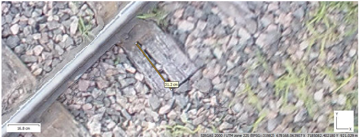
Figura 51 - Fendilhamento acima do permitido
