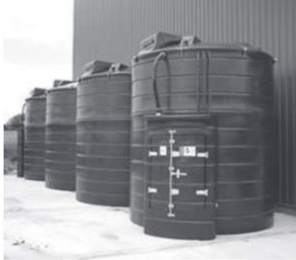
Figura 2 - Tanques de armazenamento de combustível
